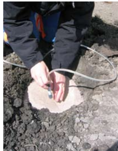
Figur 2-14 Installation av gasprob med sandfilter i tätskiktet.
