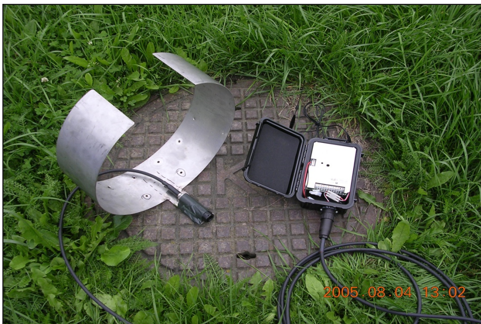
Figur 3-2. Nivågivare monterad på en ring av rostfri plåt tillsammans med en VeALogg
