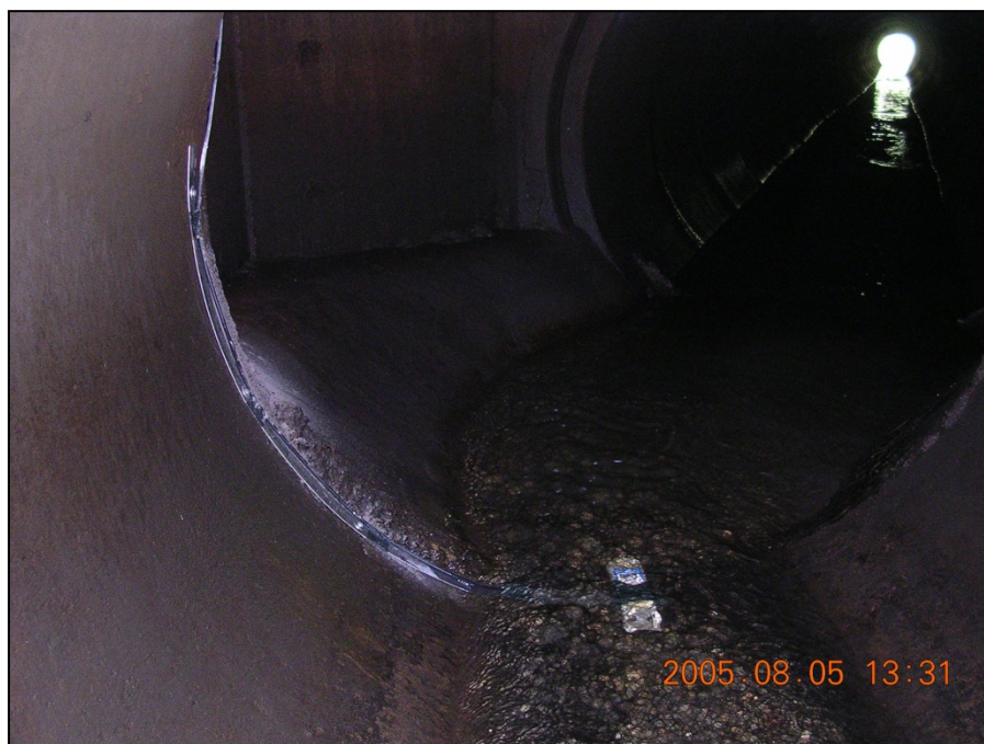
Figur Bil.3–4 Utloppsledningen i mätpunkt D1 med flödesmätarens givare monterad i vattengång
