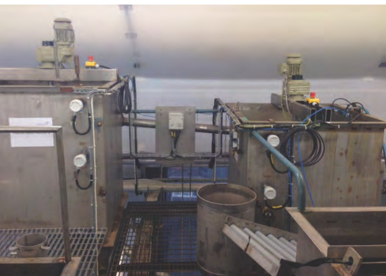
Anammox-piloten på Sjölanda avloppsreningsverk.
