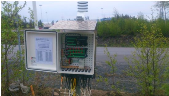
Figur 12. Datalogger för insamling av mätvärden från 22 markfuktmätare, placerade i dränområdet - under markyta ner mot och i själva svackdiket. Solbackens handelsområde, Skellefteå.
