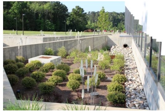
Figur 5. Dagvattenbiofilter, North Carolina, USA.
