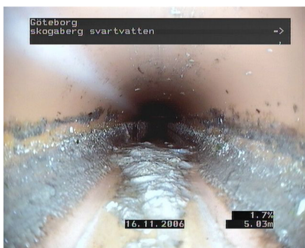
Figur 3 - Foto inifrån ledning som samtransporterar matavfall och svartvatten vid Skogabergsprojektet i Göteborg. Foto med tillstånd från Pascal Karlsson.
