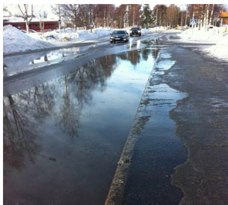
Figur 11. Tidig snösmältning på villagata av normalutförande. Notera omfattande ytlig vattenbildning!
