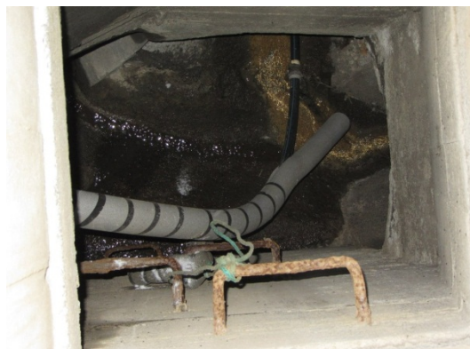
Figur 10. Exempel på ovidkommande vatten i ledningsnätet
