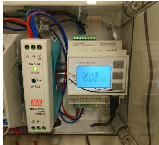
Figur 15. Reglersystem för frostskydd av grunda VA-ledningar med fjärrvärmebaserad spilluppvärmning. Styrningen baseras på aktuell marktemperatur. December 2017, Kiruna.
