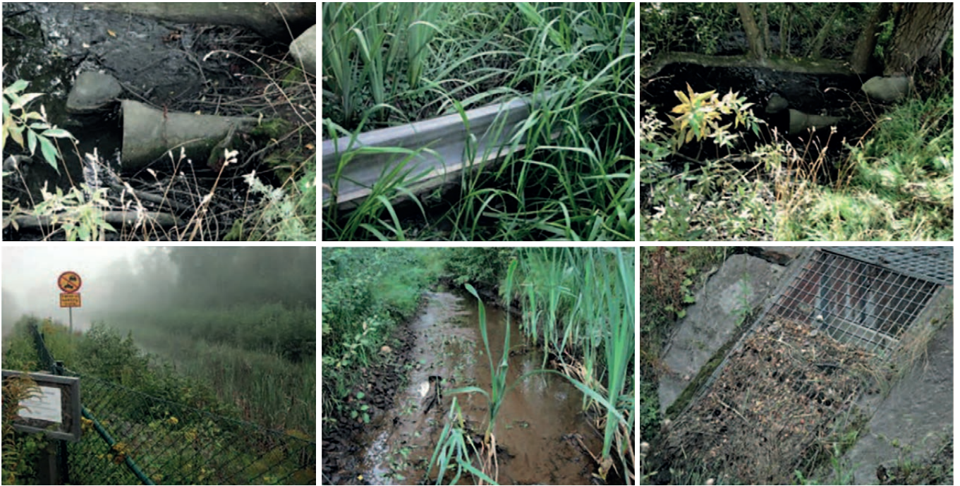
Olika problem kan uppstå med våtmarker: sedimentansamling vid inlopp, skadat utlopp, stor växtlighet vid in-/utlopp, staket förhindrar framkomlighet, sediment- och skräpansamling vid utlopp
