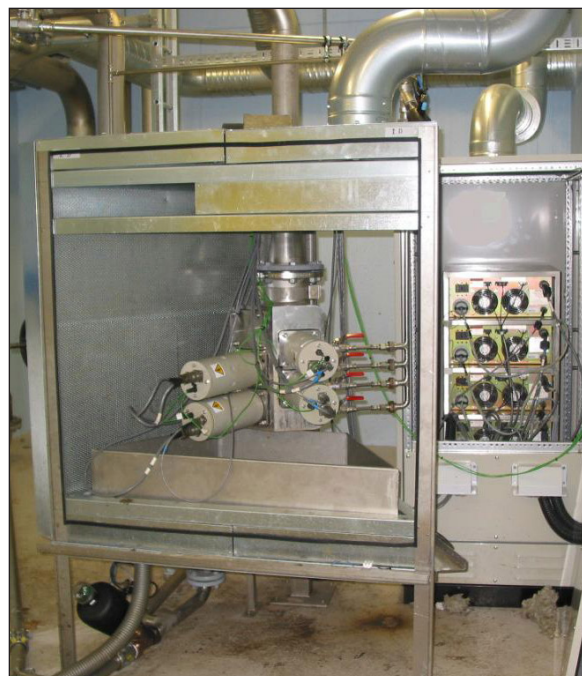
Figur 5-3. Ultraljudsanläggningen installerad på Gässlösa. (Foto Maria Dåverhög).
