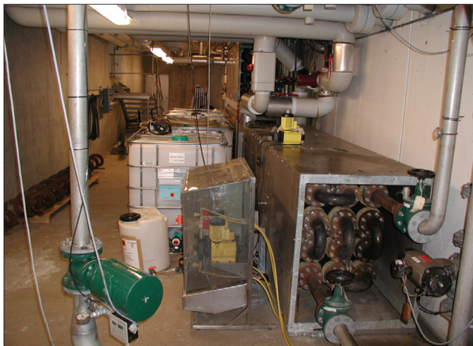
Figur 3-9. Installation för enzymtillsats på Lundtofte reningsverk, Danmark. I bakgrunden syns enzymtankarna. Främst till vänster finns pumpanordning för att pumpa in enzymerna till värmeväxlarna (till höger) där de blandas med slammet.
