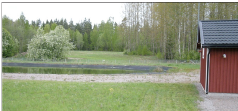
Figur 11-3 Doseringsbyggnaden och fällningsdammen i Vika Strand.
