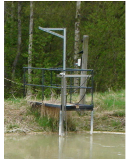
Figur 3-5 Brygga med stativ och elförsörjning till nedsänkt propelleromrörare vid fällningsdammen i Glössbo, Bollnäs kommun.
