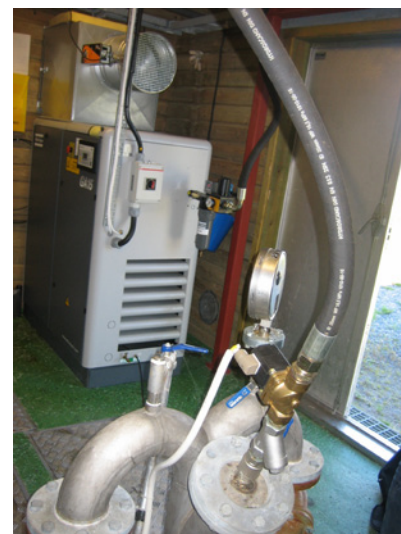
Figur 3-2 Luftspolningsanläggning i P218
