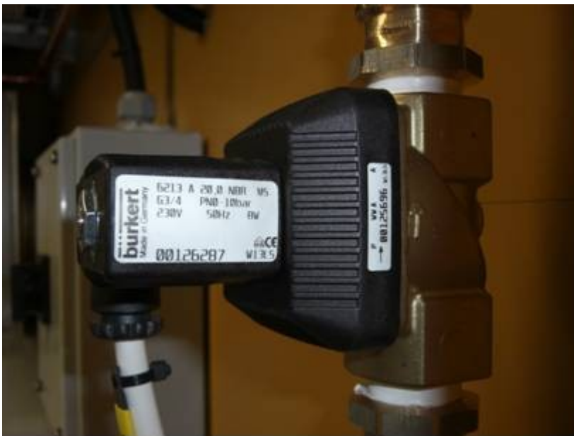
Figur 7 Bilden visar den magnetventil som har använts
