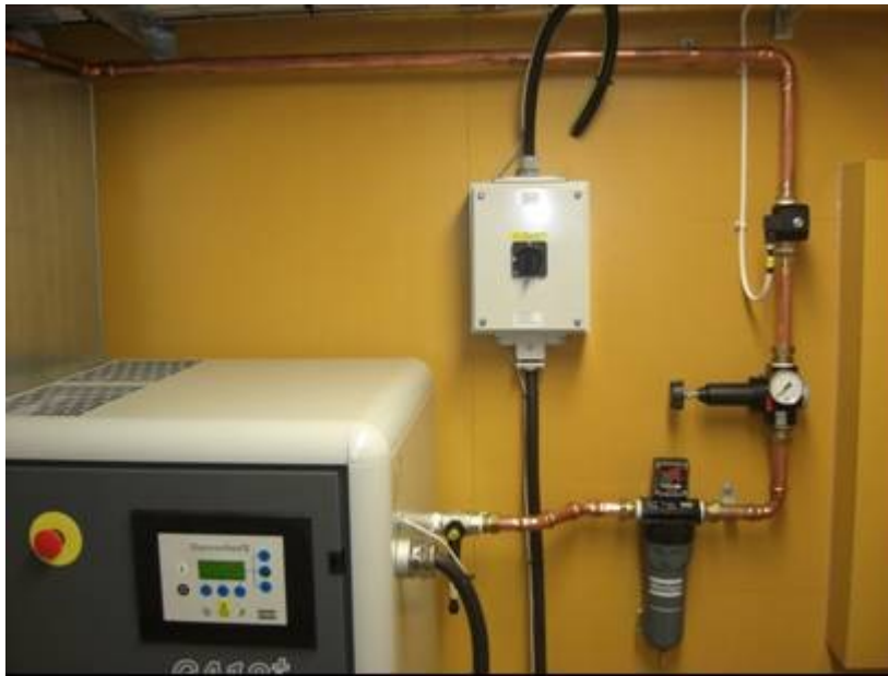
Figur 4 På utgående luftledningen från kompressorn har vi en avstängning i form av en kulventil, ett filter, en tryckregulator och en magnetventil
