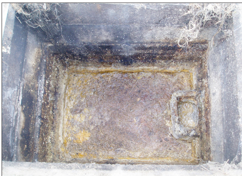
Figur 5-2 Fettpåbyggnad i en 500 mm huvudledning och en pumpstation.
