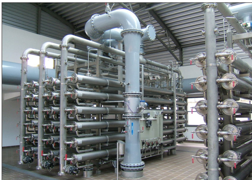
Figur 7-2 En av vattenverkets 12 membranenheter. En enhet kan vid behov flyttas ut ur byggnaden utan att andra enheter behöver flyttas.
