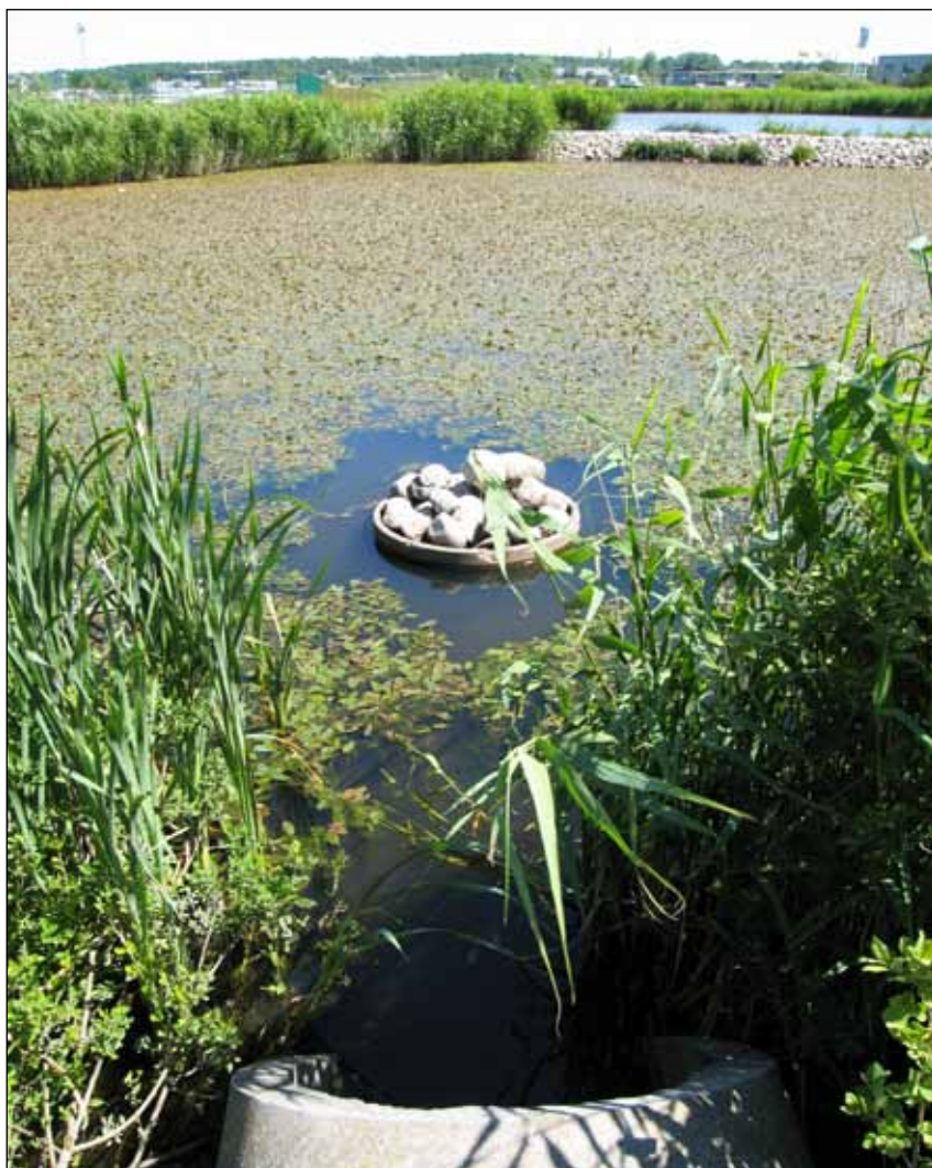
Figur B2-2 Inloppskulvert och flödesdelare. Foto: Lars Ohlsson.
