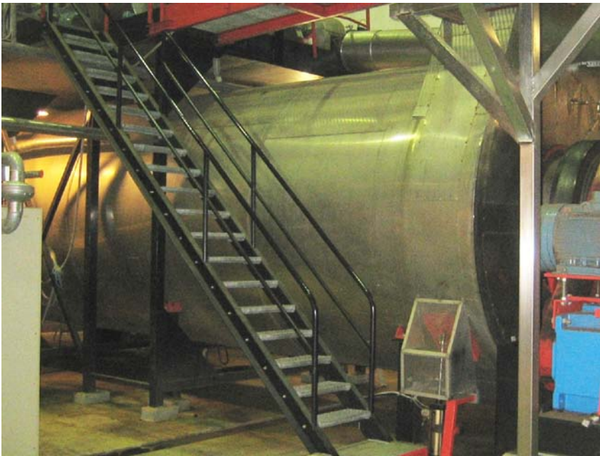
Figur 3-3 Trumma för torkning och granulering av avvattnat slam vid Himmerfjärdsverket.
