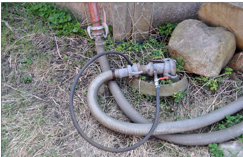
Figur 2-5 Provtagningskran som monterats på avtappningskopplingen.
