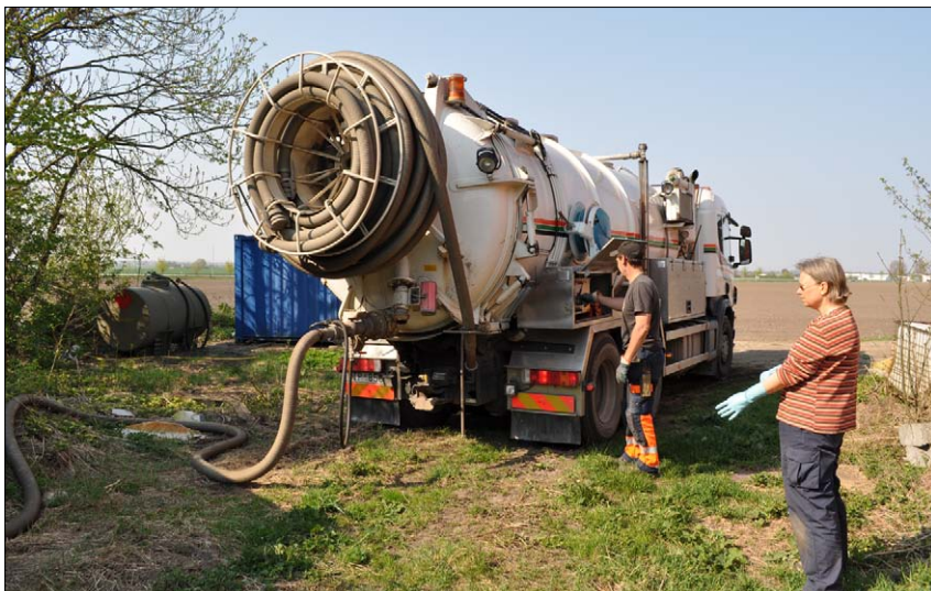
Figur 2-3 Tömning av klosettavatten i lagringsbrunnen.
