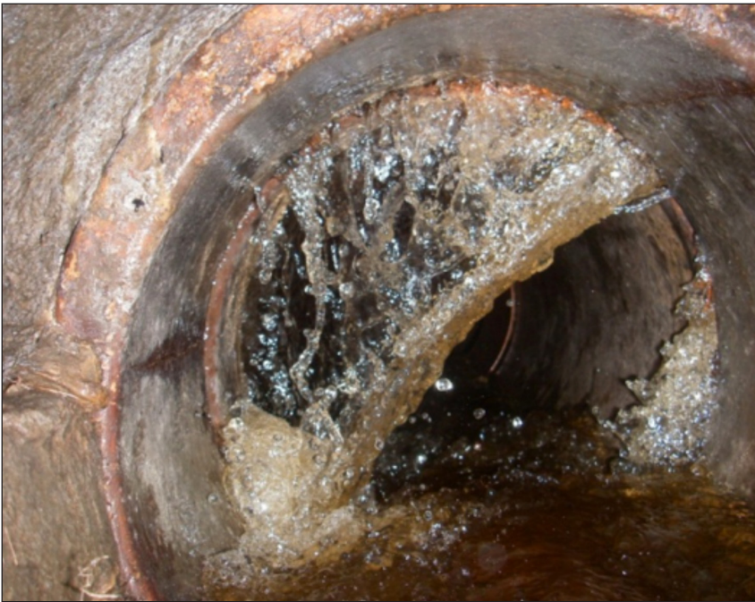
Figur 7.9 Överläckage (uppmätt flöde ca 4 l/s i en fog) från dagvattenledning som korsar den underliggande spillvattenledningen.
