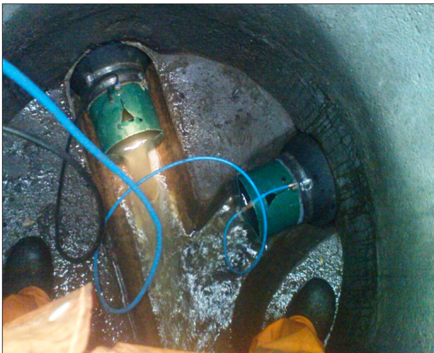
Figur 6.4 Mätöverfall monterat i två inkommande ledningar i en nedstigningsbrunn.
