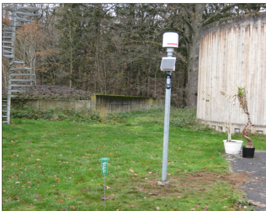
Figur 5.1 Exempel på batteridrivna nederbördsmätare med solpanel som töms via GPRS.
