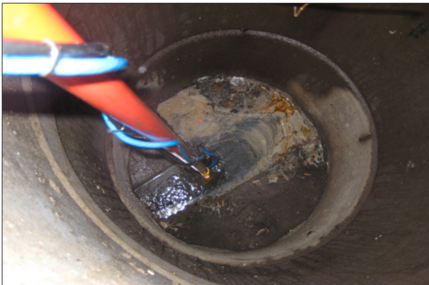
Figur 6.5 Exempel på momentan flödesmätning med V/H mätare i SNB. Nivå och hastighetsgivaren är placerad på en teleskopstång och appliceras i vattengången.
