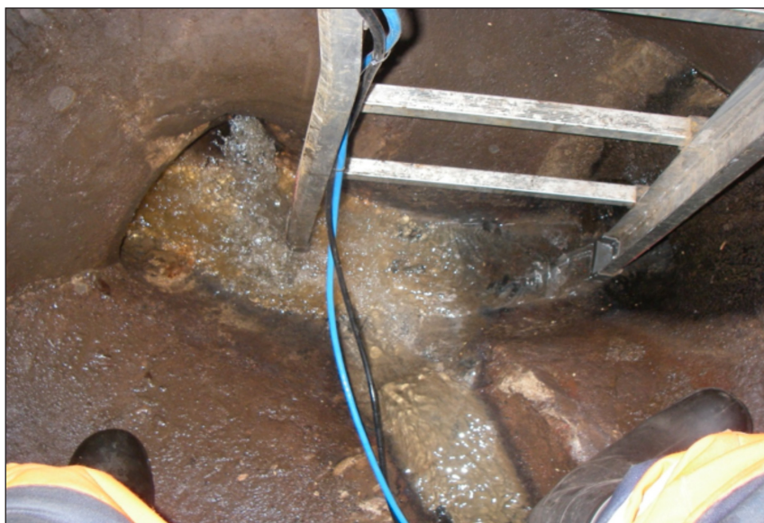
Figur 6.2 Inläckage vid utgående ledning.
