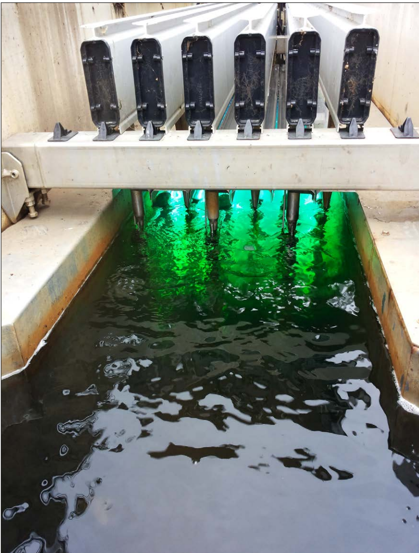
Figur 6-2 UV-anläggning Huskvarna avloppsreningsverk.
