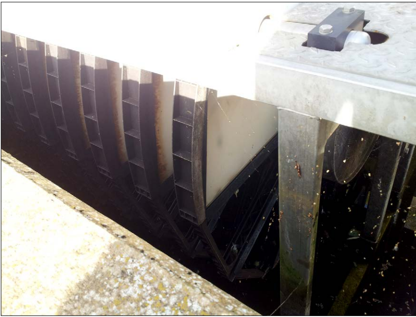
Figur 6-1 Skivfilter Huskvarna avloppsreningsverk.
