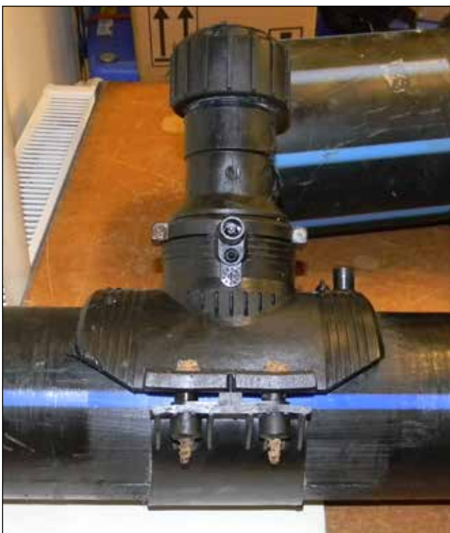
Figur 3.4.1.16 En annan sadelgren som också drabbats av läckage efter viss tid i drift.
