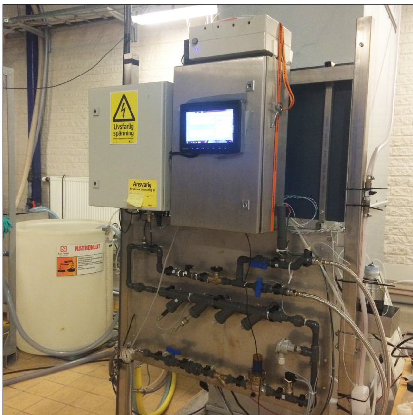
Figur 5.1 Systemet för dieseldetektion på plats vid Görvälverket består av plåtlådan i övre delen av bilden med en separat strömförsörjningsdel ovanpå. Dataskärmen visar information om sensorresponser samt beräknade koncentrationer av diesel.
