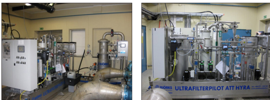
Figur 4.6 UF-pilot samt utrustning för CEB
