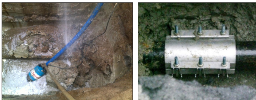
Figur 5-1 Rörbrott, typ A, på gråjärnsledning där röret gått rakt av (vänster), lagad med reparationsmuff (höger). Foto Annika Malm
