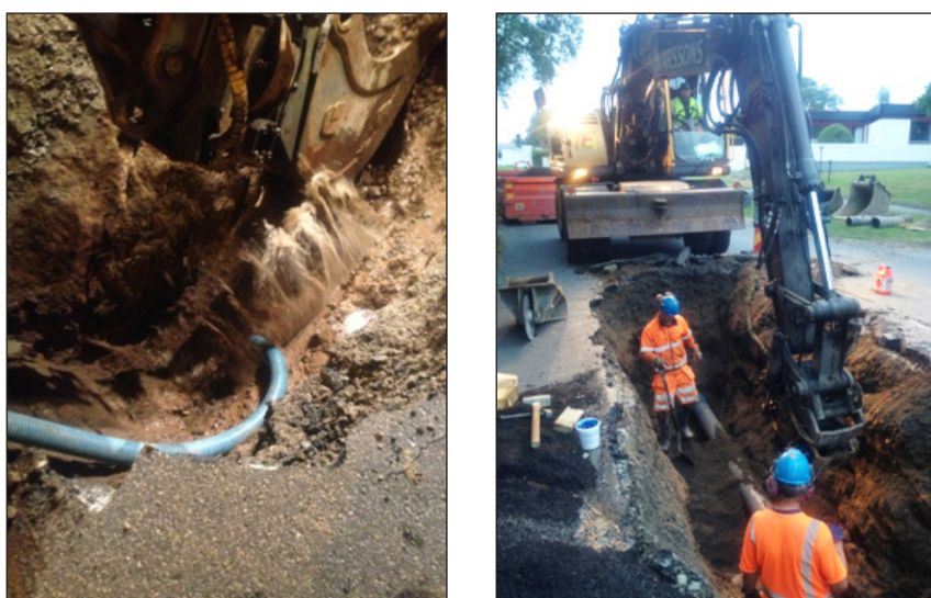
Figur 5-2 Rörbrott, typ B, på PVC-ledning där en lång spricka uppstått längs med röret (vänster) lagad med en ny ledning som skarvats in (höger) Foto Jonas Wall.
