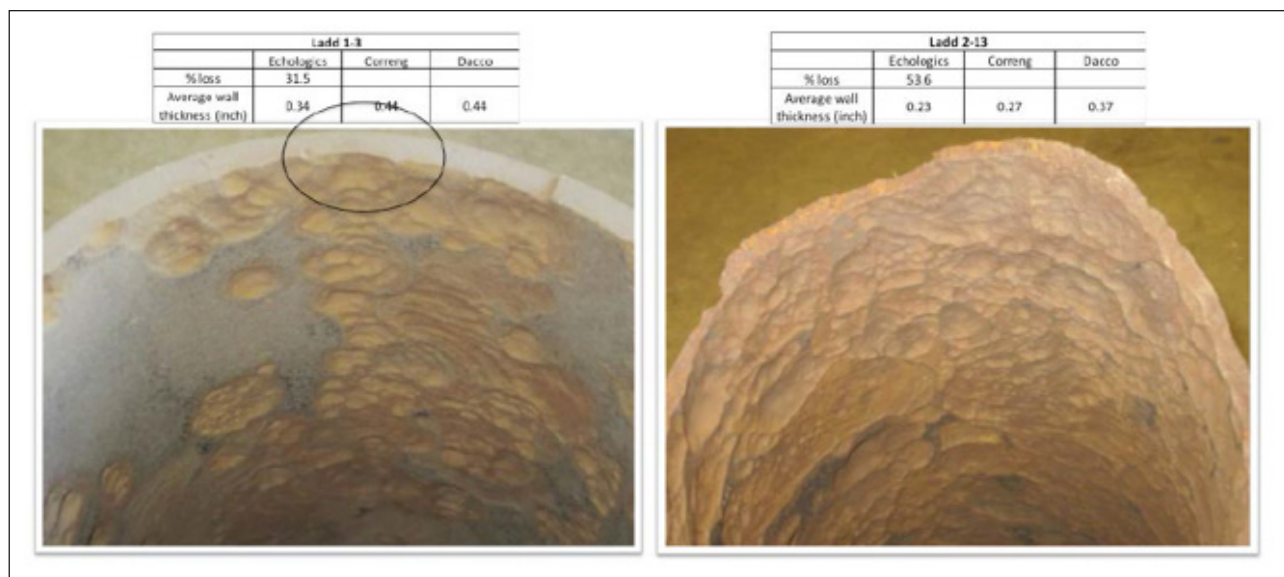
Figur 2.3 I projektet testades två närliggande ledningar med den akustiska metoden där metoden klarade av att detektera ledningen med tunnare godstjocklek. Kompletterande mätningar av godstjockleken gjordes med forensiska analyser från två oberoende laboratorier. Echologics resultat visade på en tunnare godstjocklek än resultatet från laboratorierna [7].
