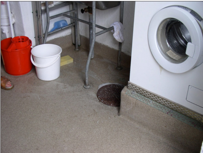
Figur 5-3 Tvättmaskin placerad upphöjd från källargolv, Växjö 2003 (Sweco).
