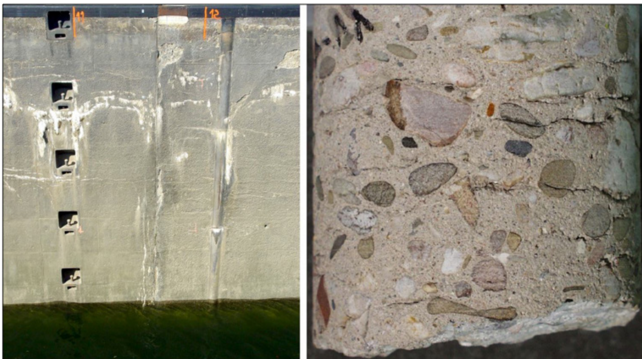
Figur 5-6 Sulfatangrepp i bassängvägg där en svällande gel har bildats vilken spränger sönder betongen inifrån. Resultatet blir att betongen spricker upp och hållfastheten minskar. Bilden är från en vattendamm dvs. inte från ett vattenverk.
