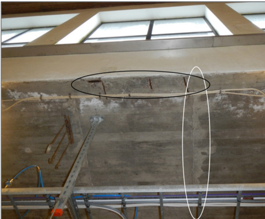
Figur 5-21 Armeringskorrosion på undersidan av en balk (svart markering). Korrosionen har troligen uppstått på grund av vattenläckage utifrån och ett tunt täckande betongskikt. Man kan också se kalkutfällningar och sprickor (vit markering) i taket vilka också visar på att vatten har läckt in i byggnaden utifrån.
