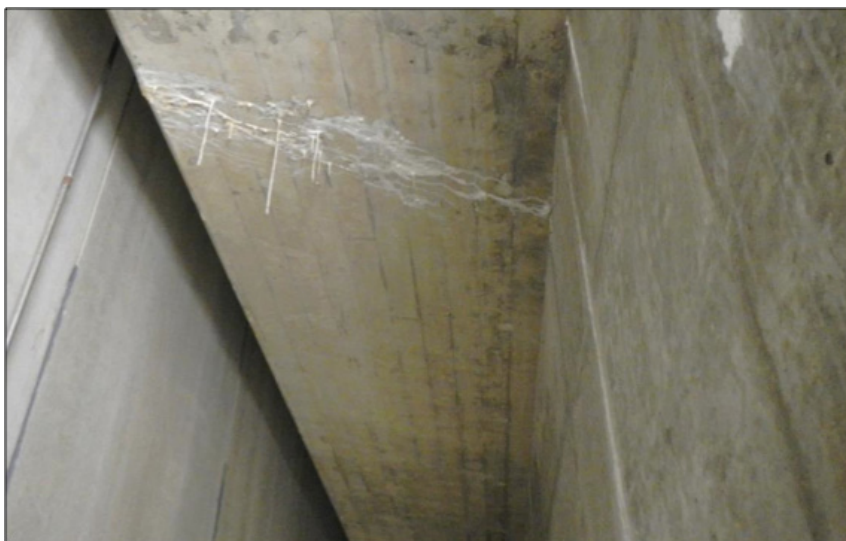
Figur 5-19 Stalaktiter och spricka i en balk.
