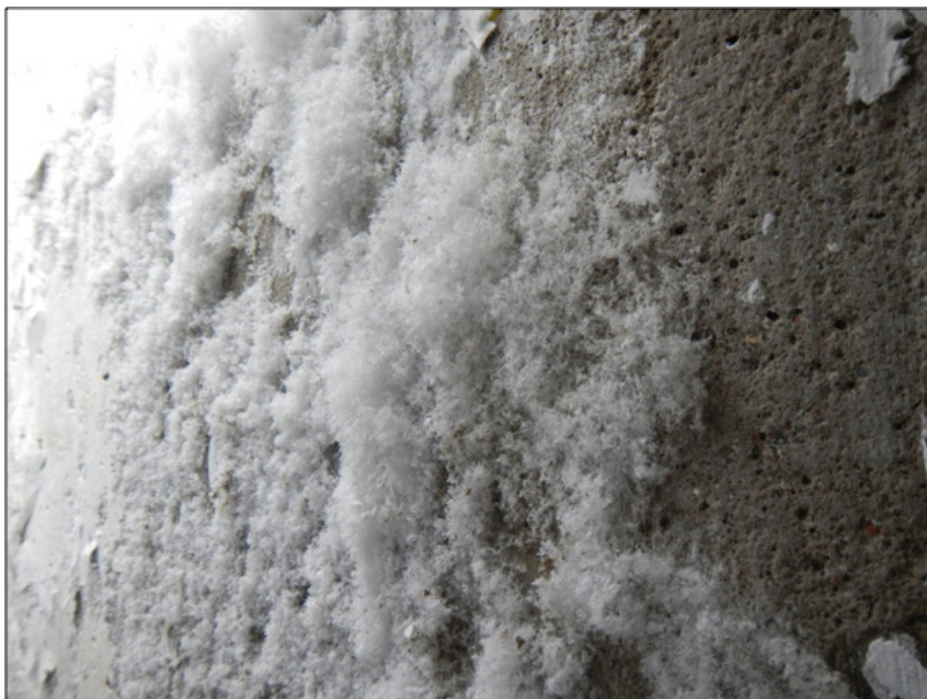
Figur 3-4 Fukt som transporteras genom en betongkonstruktion kan bildas saltkristaller på bassängväggens "torra sida" när fukten avdunstar.
