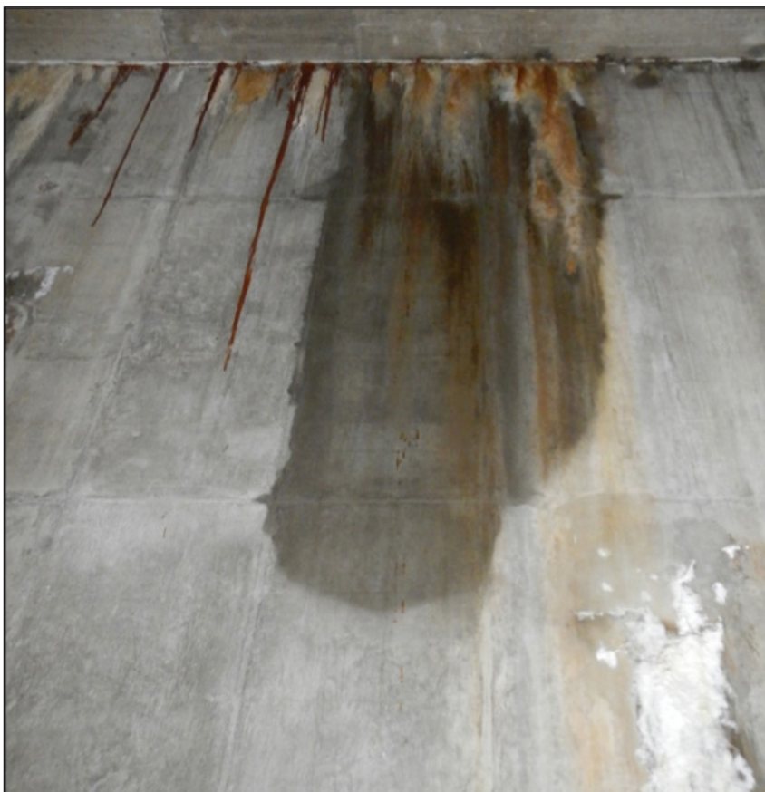
Figur 3-3 Fukt och kalkavlagringar på den torra sidan av en betongkonstruktion.
