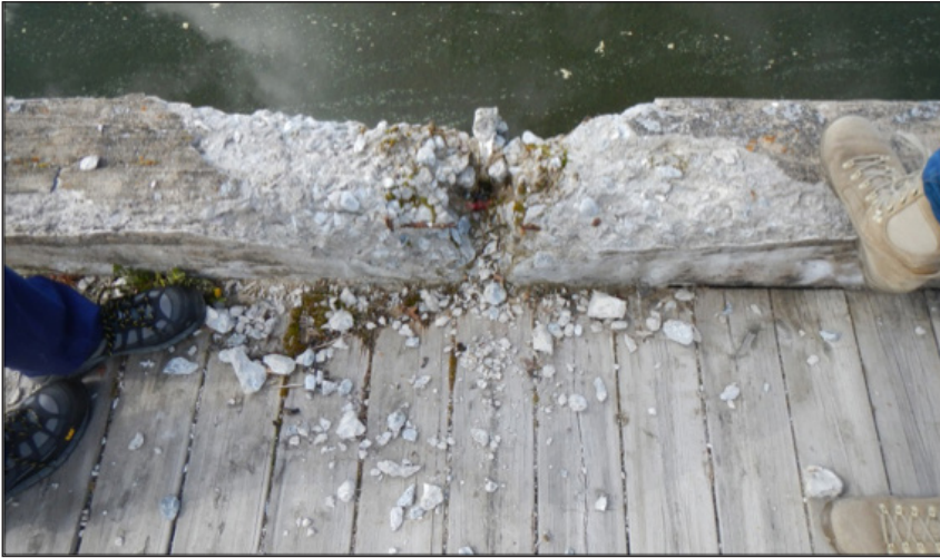
Figur 3-16 Långt gången frostsprängning har gjort att lager efter lager betong har skalats av.
