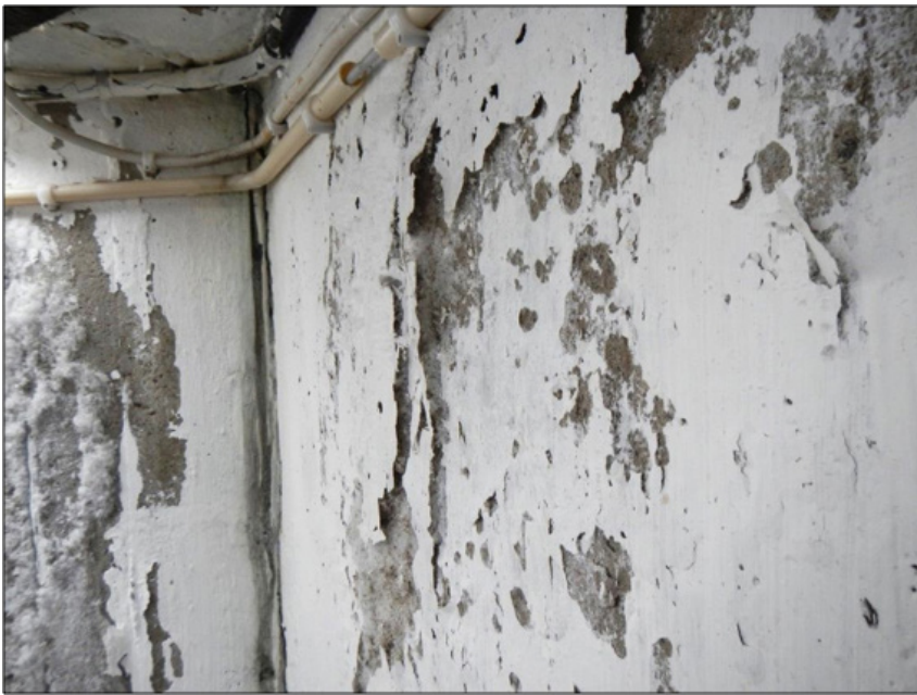
Figur 5-16 Väggen är målad med en icke genomsläpplig färg. När fukt transporteras genom väggen kan den inte passera färgen. Resultatet blir blåsor i färgen, avskalning av betong och utfällning av kalk och saltkristaller.
