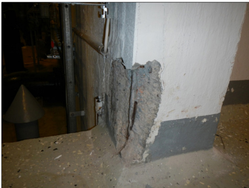
Figur 5-22 Fukt har troligen trängt in i konstruktionen så att armeringsjärnen i pelaren har kunnat börja korrodera. Det är inte helt osannolikt att pelaren har utsatts för någon form av åverkan, vilket i så fall kan ha initierat fuktrinträngningen.
