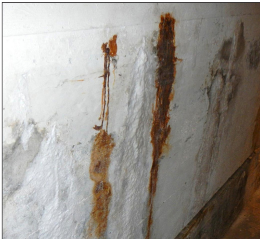
Figur 3-7 Rostfläckar på en betongkonstruktions utsida.
