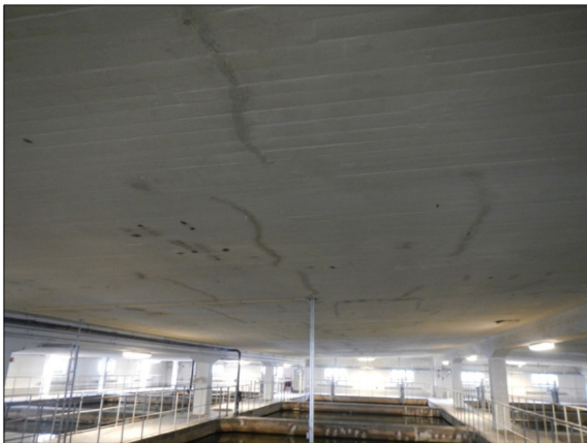
Figur 5-24 Sprickor och rostgenomslag i taket på ett vattenverk.
