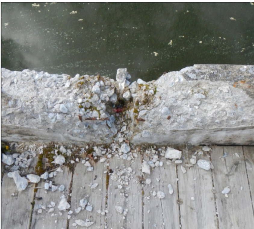
Figur 5-13 Frostskada i ett långsamfilters bassängsarg.
