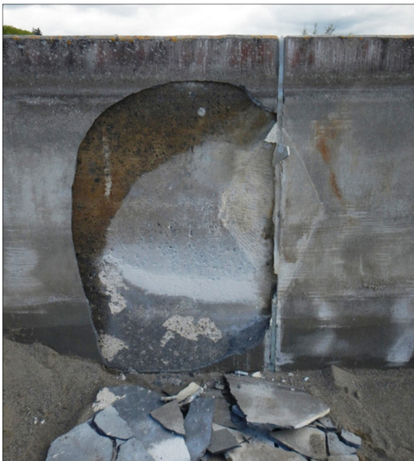
Figur 6-4 Långsamfilterbassäng som putsats invändigt. Vidhäftningen har inte varit tillräcklig så putsen lossnade när bassängen tömdes på vatten.
