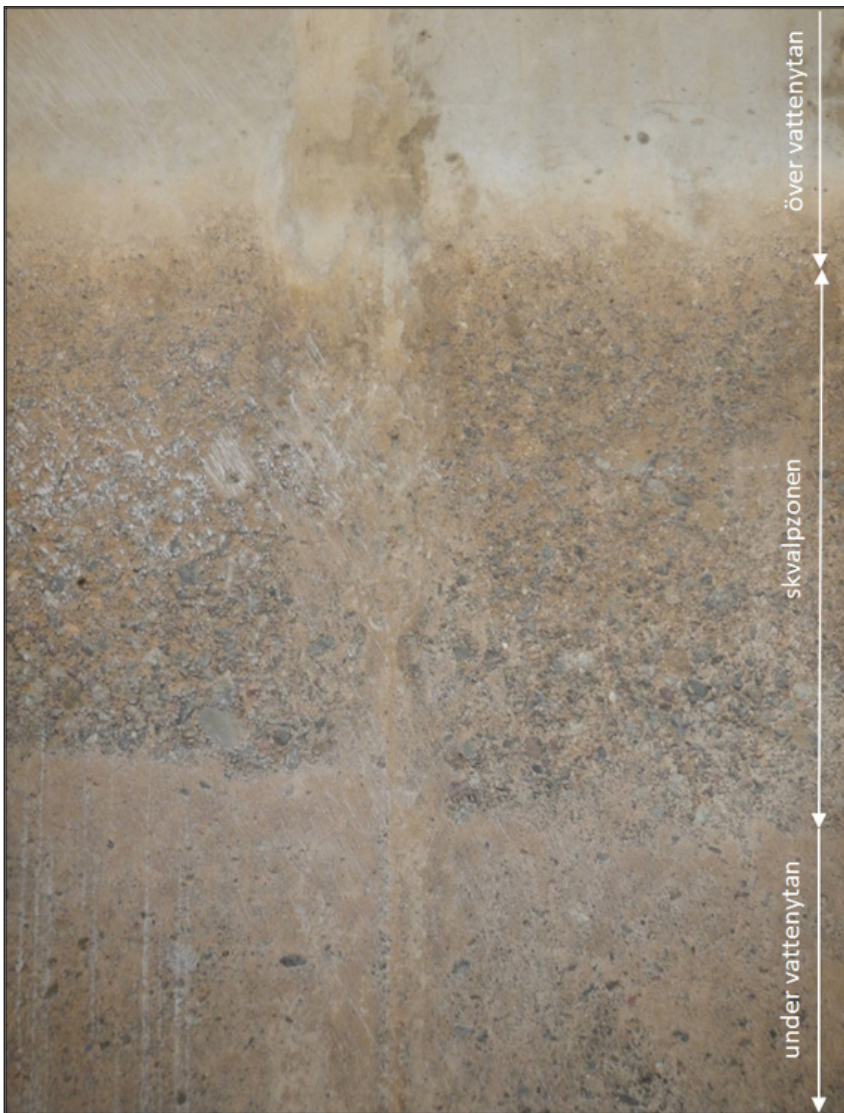
Figur 3-17 Betong som ständigt varit under vattenytan är relativt mindre skadad än betongen som varit i skvalpzonen (området runt vattenlinjen). Betongen som befunnit sig över vattenyta är också relativt oskadad.
