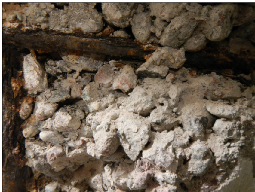
Figur 3-21 Dåligt kompakterad betong gör att ballasten ligger fri från cementpastan vilket försämrar hållfastheten.
