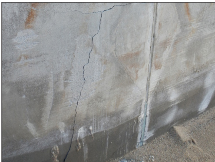
Figur 3-13 Spricka i en pågjutning i en långsamfilterbassäng.
