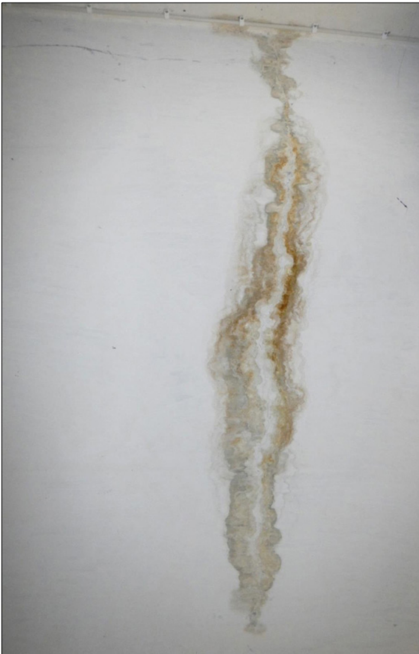
Figur 5-15 Fuktgenomslag och kalkavlagningar på bassängvägg.
