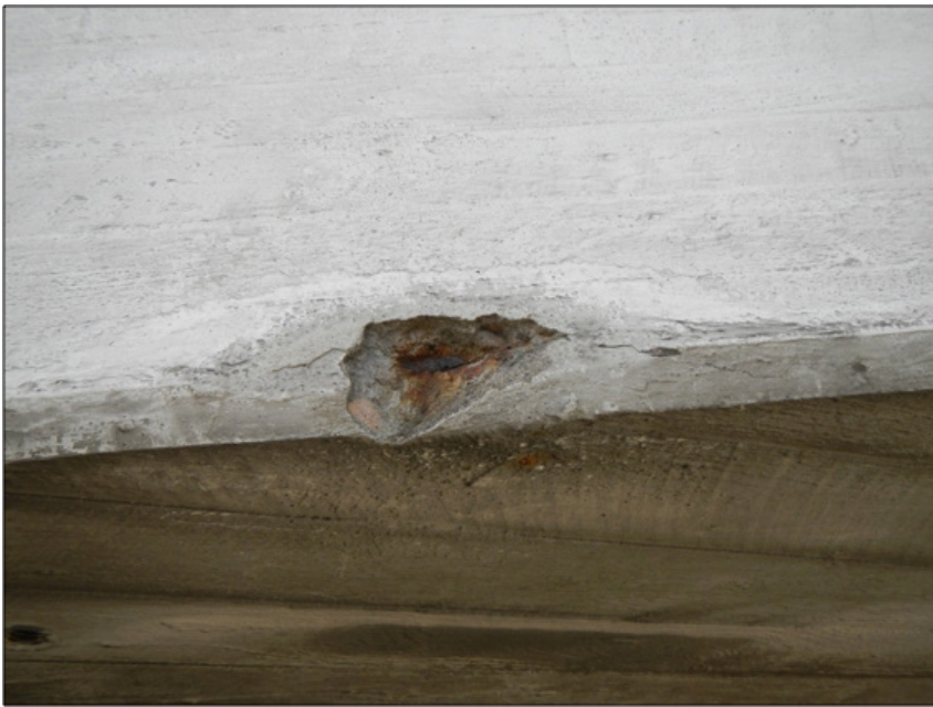
Figur 5-28 Armeringskorrosion på undersidan av ett vattentorns reservoar.
