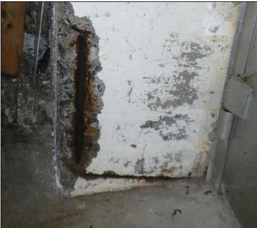
Figur 3-9 Pelare där det ingjutna armeringsjärnet har korroderat och det täckande betongskiktet har spjälkats av.
