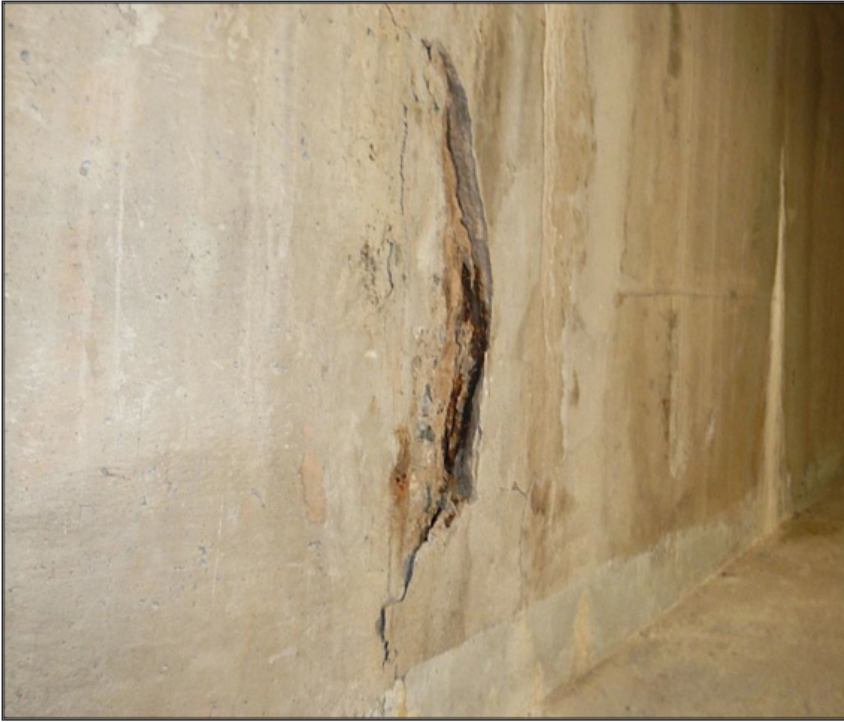
Figur 3-8 Armeringsjärnen har korroderat och det täckande betongskiktet har därför spjälkats loss.
