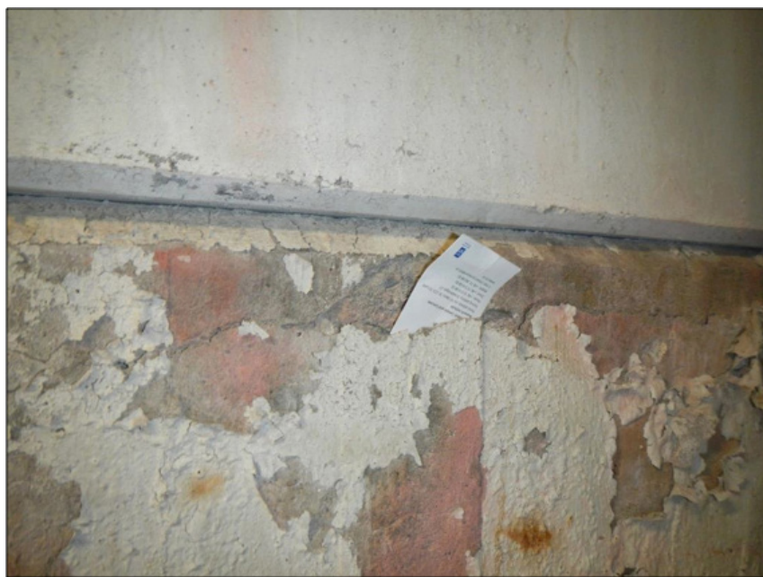
Figur 5-2 Spricka i betongkonstruktion där korrosion av armeringsjärnen har börjat spjälka av.
