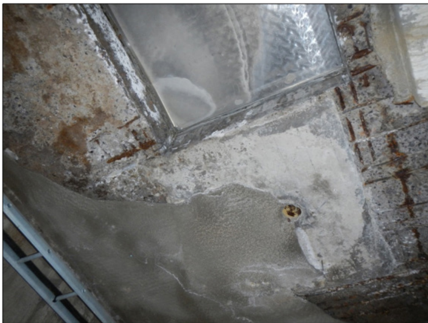
Figur 6-2 Armeringskorrosionsskador som inte förarbetas och lagas på ett fackmannamässigt sätt innan sprutbetongen applicerades, resulterar i att betonglagningen fallit ned då reparationsbetongen saknar vidhäftning mot underlaget.
