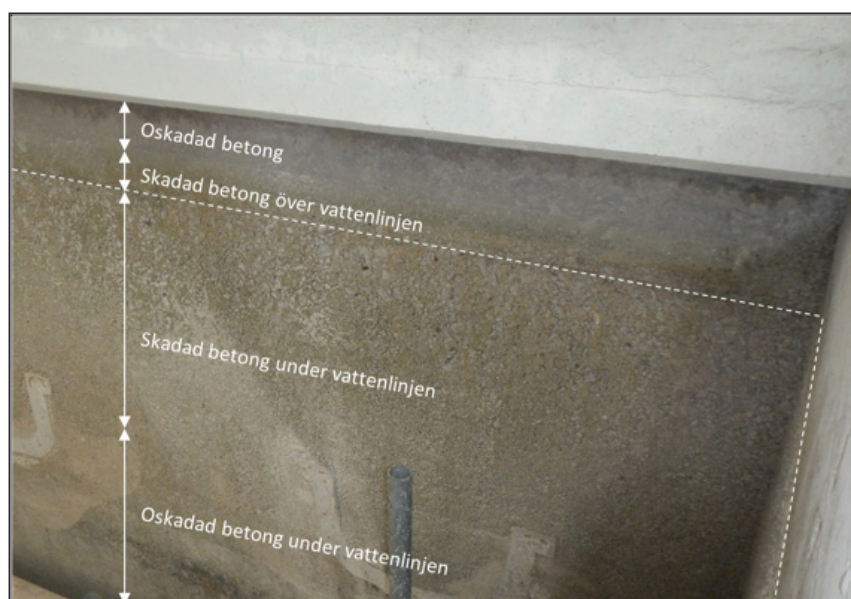
Figur 3-1 Synliga skador på betong uppstår ofta runt vattenlinjen.
