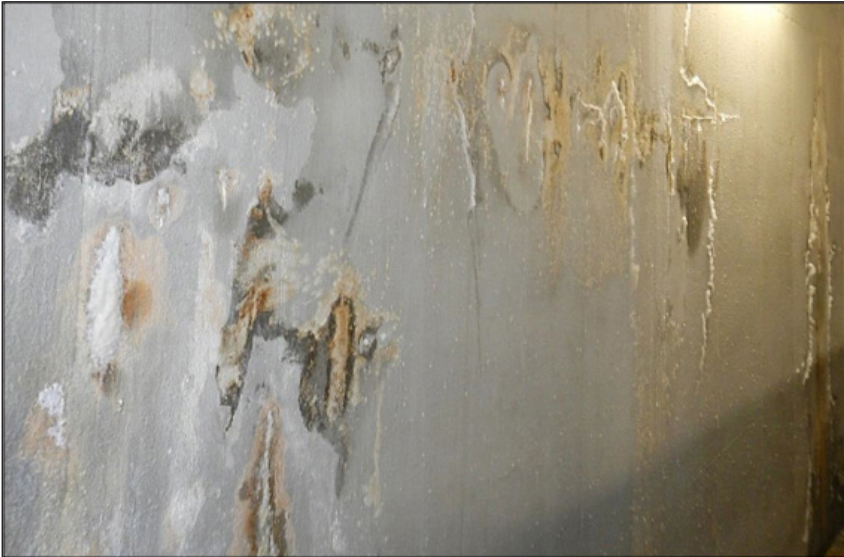
Figur 3-2 Läckage och salt/kalk-utfällningar på den torra sidan av en bassäng uppkommer då vatten läcker genom en betongkonstruktion.
