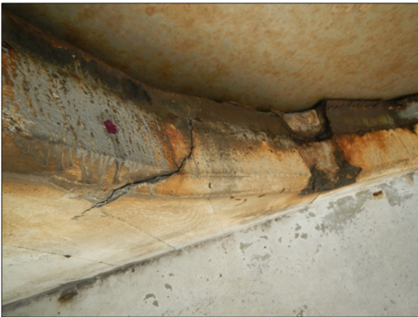
Figur 5-27 Armeringskorrosion på undersidan av ett vattentorns reservoar. Betongbitar riskerar att falla ned och orsaka personsador. Dessutom kan konstruktionens bärighet vara i fara om inte omedelbara reparationer görs.
