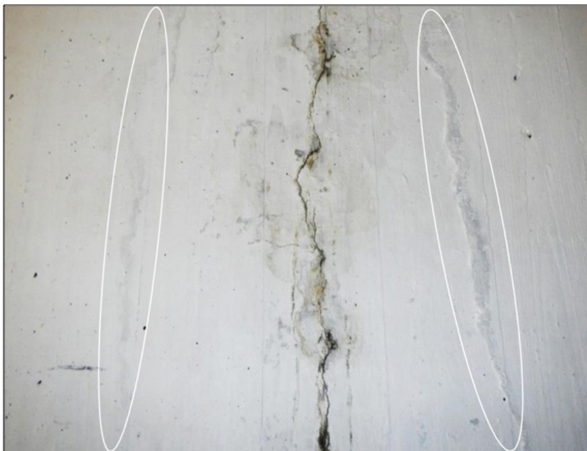
Figur 5-18 Spricka i betongkonstruktionens utsida. Läckage förekommer genom sprickan och salter har fäls ut en bit bort från sprickan (vita markeringar) där väggen är tillräckligt torr.
