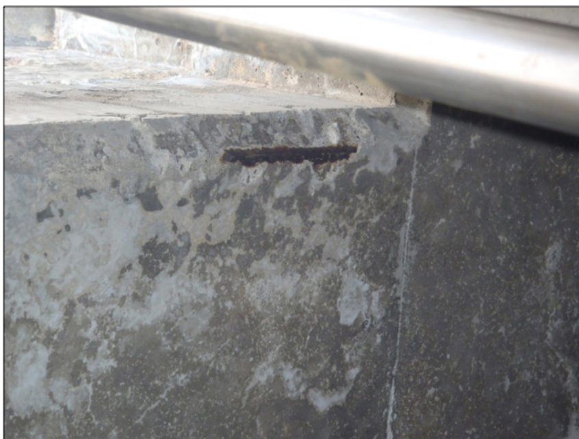
Figur 5-25 Armeringskorrosion på insidan av ett vattentorns reservoar. Troligen har armeringskorrosionen startats av att täcksiktet varit för litet vid gjutningen.
