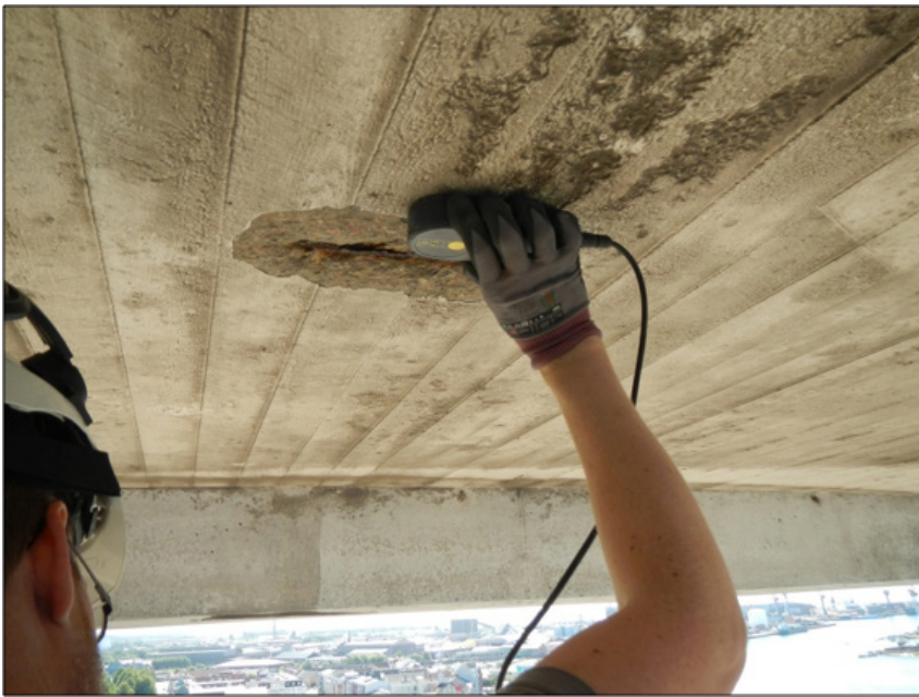
Figur 5-26 Armeringskorrosion på undersidan av ett vattentorn. Armeringen har troligen rostet på grund av ett för tunt täckskikt i kombination med bristfälliga karbonatiseringshämmande åtgärder.
