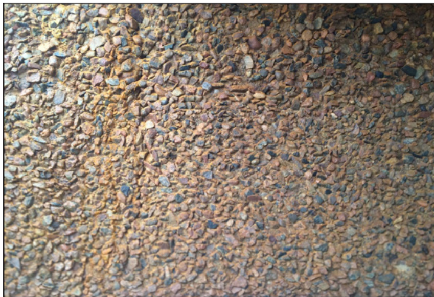
Figur 3-18 Hela betongytan har eroderat bort och endast ballasten är kvar i ytan. Denna bild är från den kemiska industrin.
