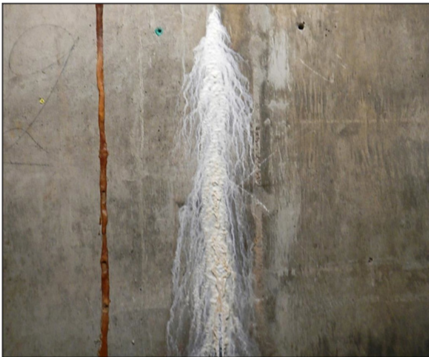
Figur 3-5 Kalkutfällning på betongkonstruktions "torra" sida.
