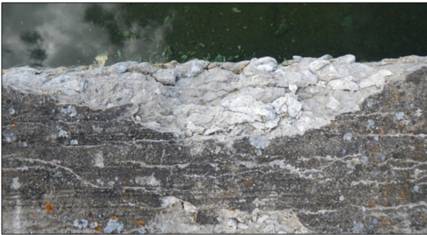
Figur 3-10 Del av frostsadad betongkonstruktion. Betongen har spruckit och spjälkats av.
