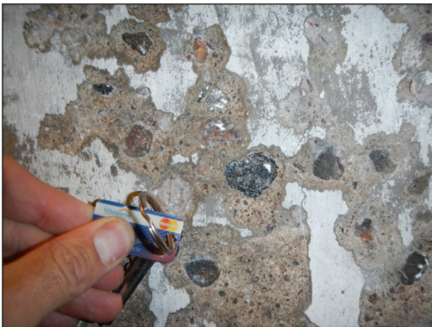
Figur 3-15 Det yttersta skiktet på en betongkonstruktion har skalats av dvs. lossnat och fallit bort.
