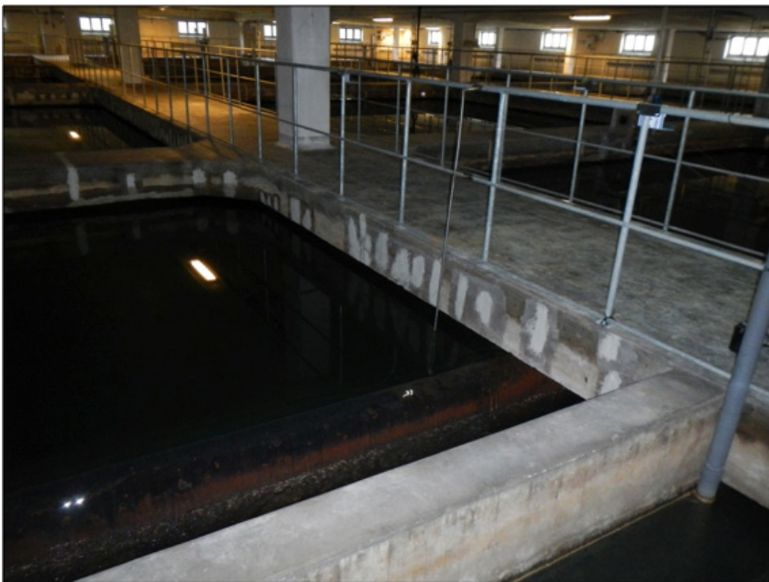
Figur 5-9 Reparerade korrosionsskador. Skadorna har troligen inte lagats på ett lämpligt sätt och lagningen riskerar att falla av igen.
