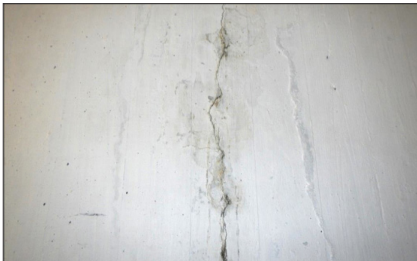
Figur 3-12 En läckande spricka i en betongkonstruktion med saltavlagringar runt om läckageområdet.
