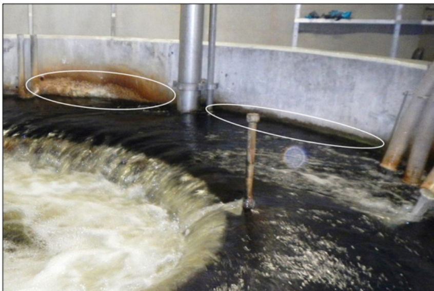
Figur 5-3 Råvattensnäcka med kalkutfällning och viss mekanisk erosion i vattenytanivån.
