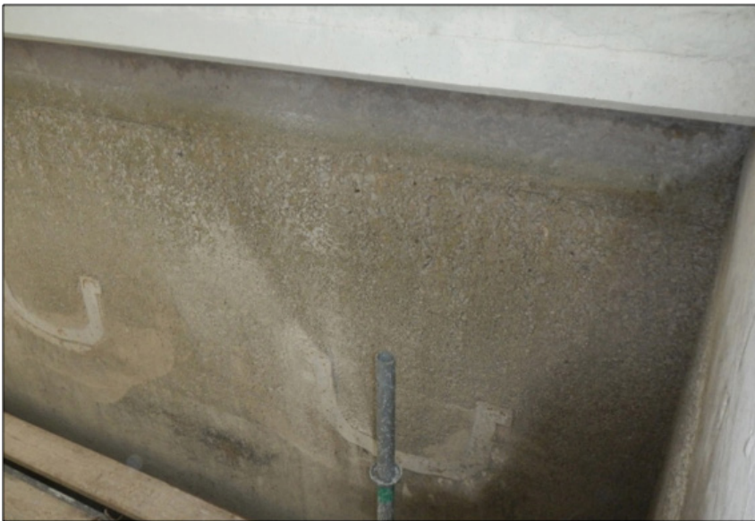
Figur 5-8 Erosion av betongytan skapad av den övre delen av vattnets rörelser i en snabbfilterbassäng.
