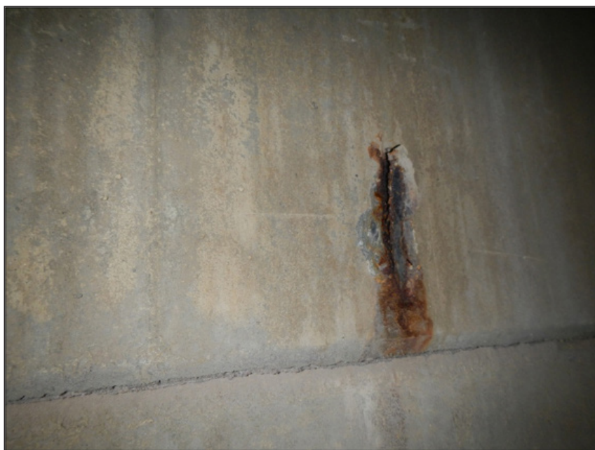
Figur 4-1 Rost har en större volym än de ursprungliga armeringsjärnen vilket gjort att betongskiktet utanpå järnen har spjälkats loss och fallit av.
