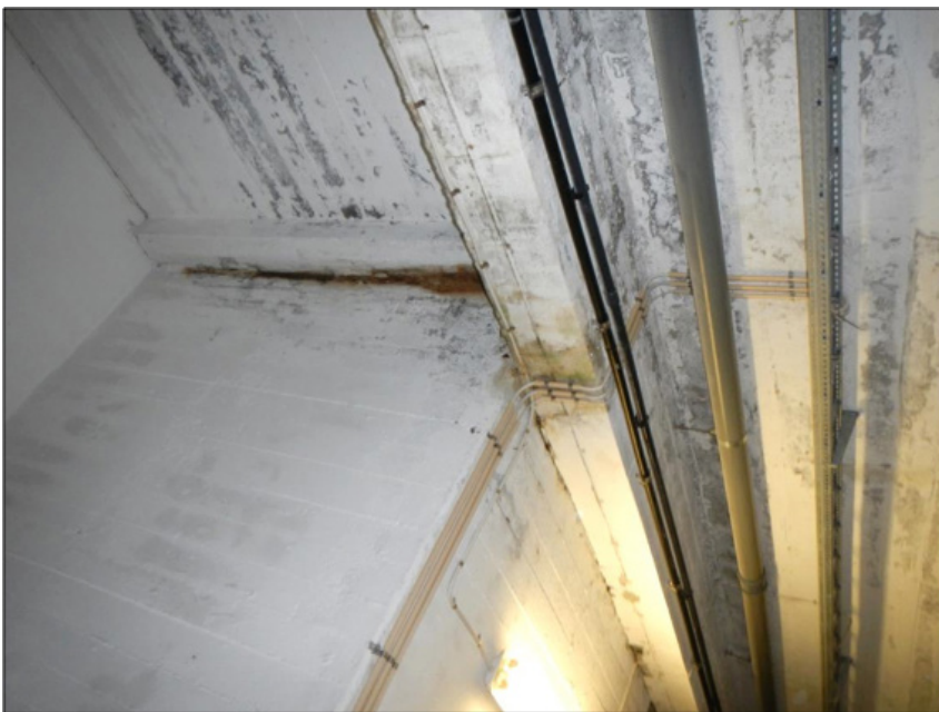
Figur 5-17 Omfattande kalkutfällning i taket under en bassäng.
