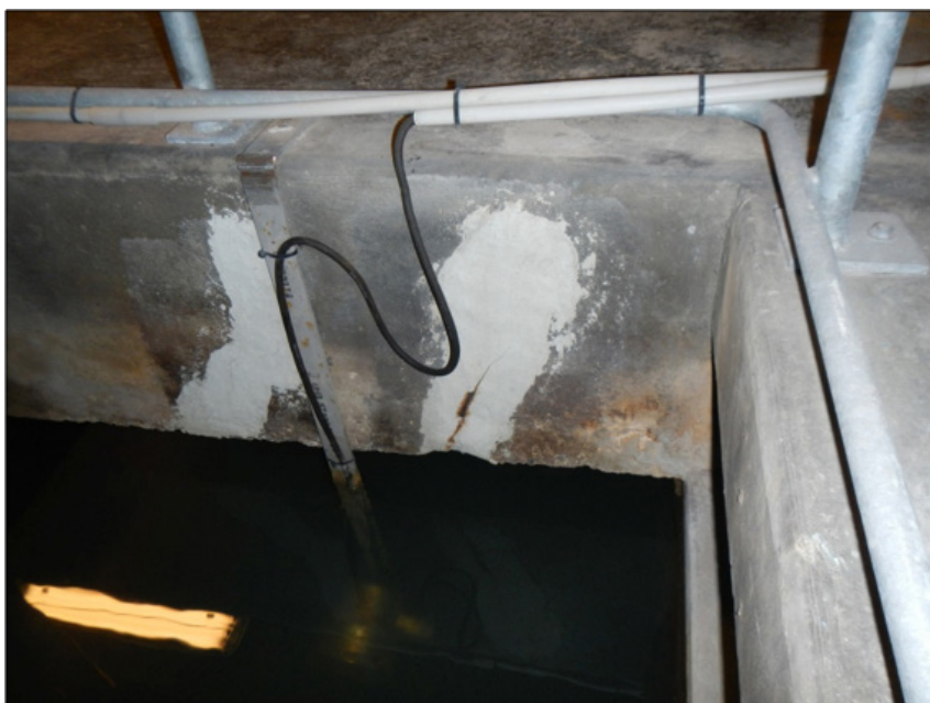
Figur 5-23 Eftersom armeringskorrosionsskadan har reparerats på ett felaktigt sätt, har korrosionen fortsatt. På sikt kommer även de nya lagningarna att falla av.
