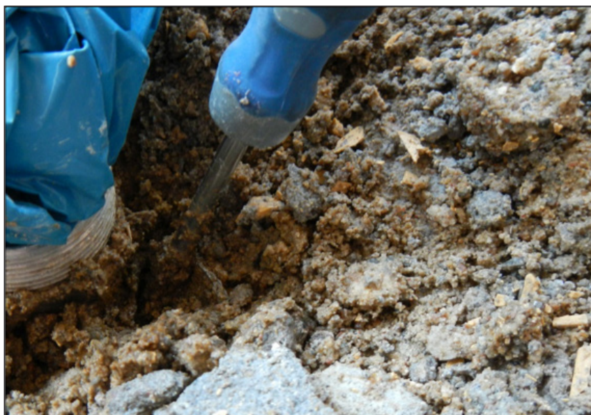
Figur 3-20 Cementpastan har försvunnit och endast ballasten är kvar. Ofta sker en färgförändring i betongen till det ljusare. Bilden är från ett badhus.
