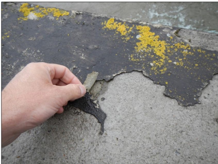
Figur 6-1 Epoxibeläggning applicerad på betongen runt om ett långsamfilter. En felaktig/felaktigt lagd beläggning kan försämra betongens beständighet.
