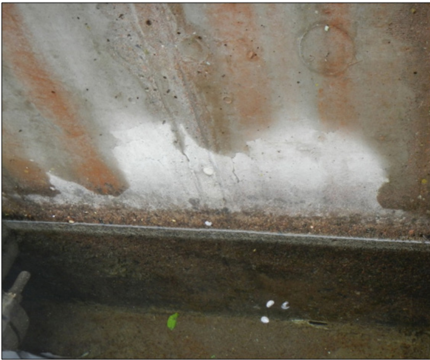
Figur 5-12 Erosion ovan vattenlinjen i ett långsamfilters betongkonstruktion.
