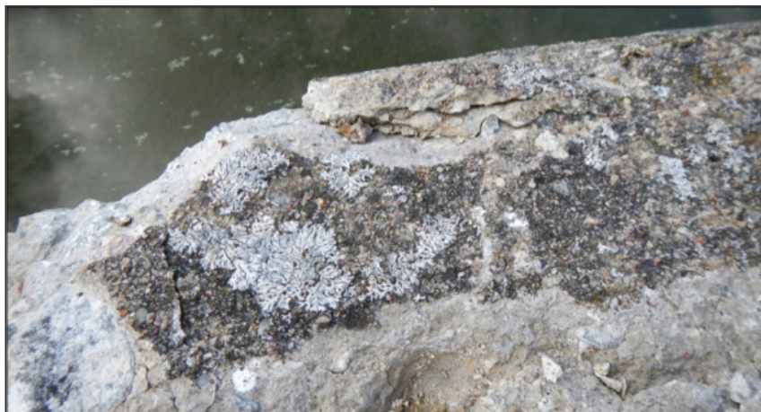
Figur 4-2 Typisk frostskaada i en utomhusbelägen betongkonstruktion.
