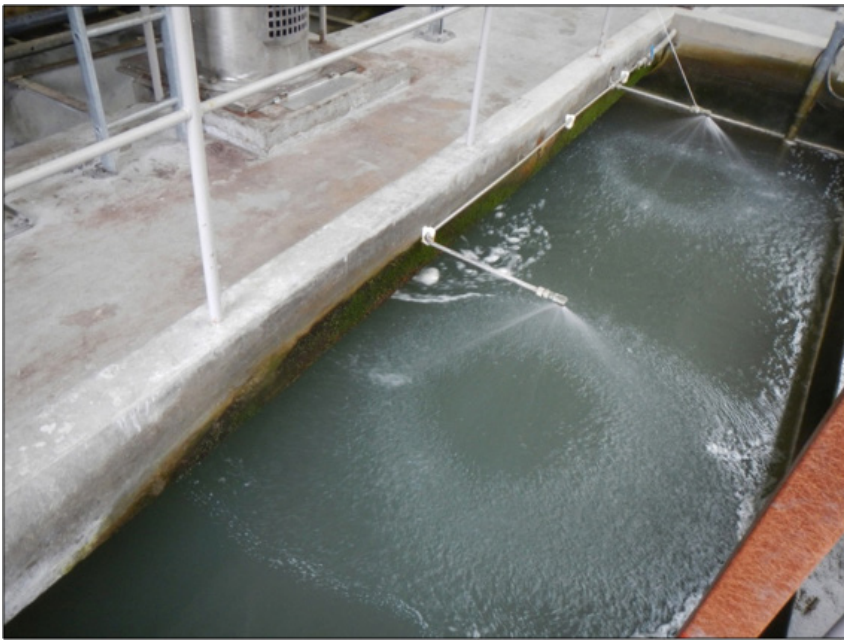
Figur 5-4 Flockningsbassäng med sprinkler vilken tillsätter flockningsmedel till vattnet.
