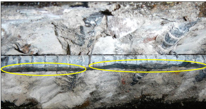
Figur 3-11 Vid svartrost transporteras järnjoner bort så att armeringen riskerar att "försvinna" på sikt.
