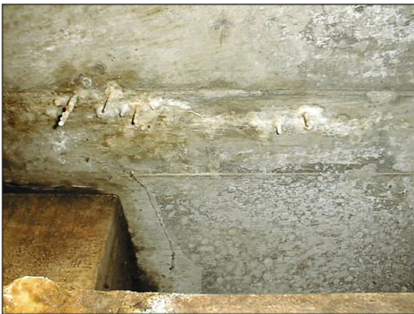
Figur 3-6 Stalaktiter bildade på undersidan av en betongkonstruktion.
