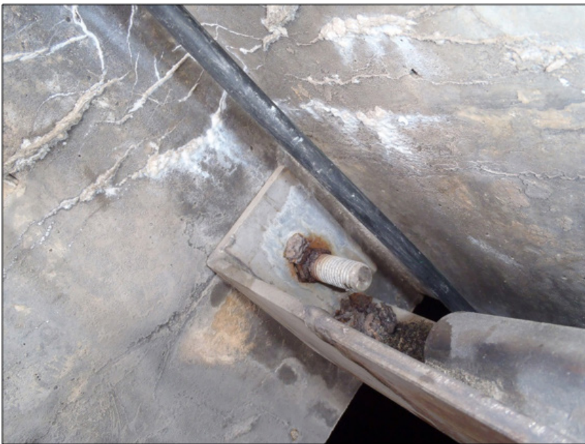
Figur 5-29 Sprickor med utfälld kalk i undersidan av takets insida på en vattenreservoar. Notera den rostiga muttern.
