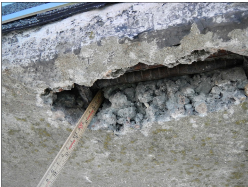
Figur 5-30 Gjutsår på ett vattentorns utsida. En luftficka har bildats under gjutningen av betongen. Armeringsjärnen riskerar att börja rosta då det inte finns någon betong som skyddar dem.
