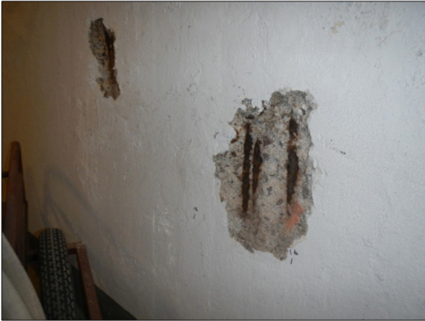
Figur 5-20 Armeringskorrosion i bassängväggen har gjort att det täckande betongskiktet har spjälkats loss.
