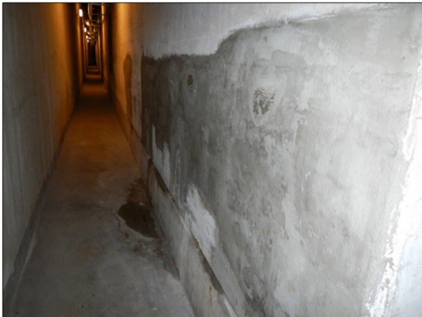
Figur 6-3 På den torra sidan av en bassäng har armeringskorrosion gjort att det täckande betongskiktet har spjälkats av. Skadan har lagats genom att försöka hindra vatten att tränga ut från betongytan genom att applicera en vattentät produkt på utsidan. Betongen runt armeringsjärnen har inte rensats och armeringsjärnen har inte kompletterats vilket gör att rostangreppet fortsätter och lagningen kommer att falla av.
