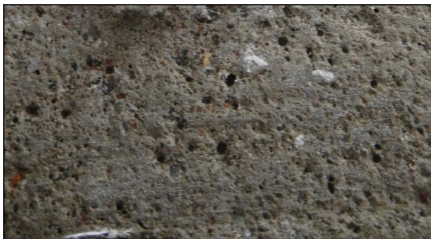
Figur 3-19 Porös betongyta orsakad av urlakning.
