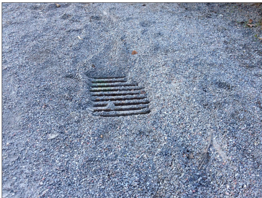
Figur 20-1. Rännstensbrunn med möjliga driftproblem och nedsatt kapacitet.
