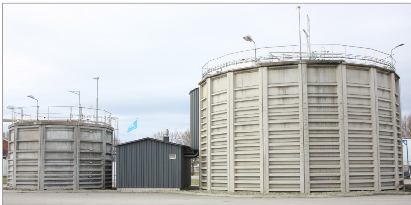
Figur 8-1 Utjämningsbassäng, pumpbyggnad samt SBR vid Slottshagens avloppsreningsverk.
