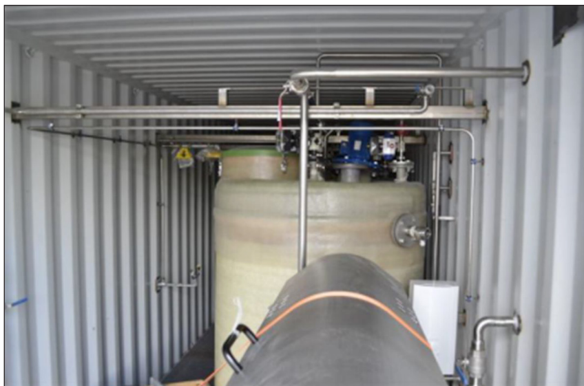
Figur 8-18 Pilotanläggning för struvitfällning inrymd i container vid Öresundsverket, Helsingborg. Foto: Ekobalans Fenix AB.
