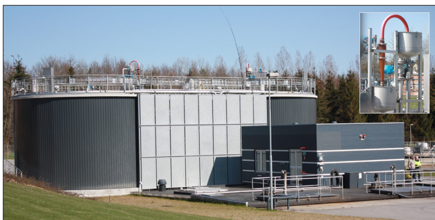
Figur 8-13 De två DEMON®-reaktorerna vid Ejby Mølle avloppsreningsverk. Hydrocyklonerna syns på reaktorernas toppar samt infällt i övre högra hörnet.
