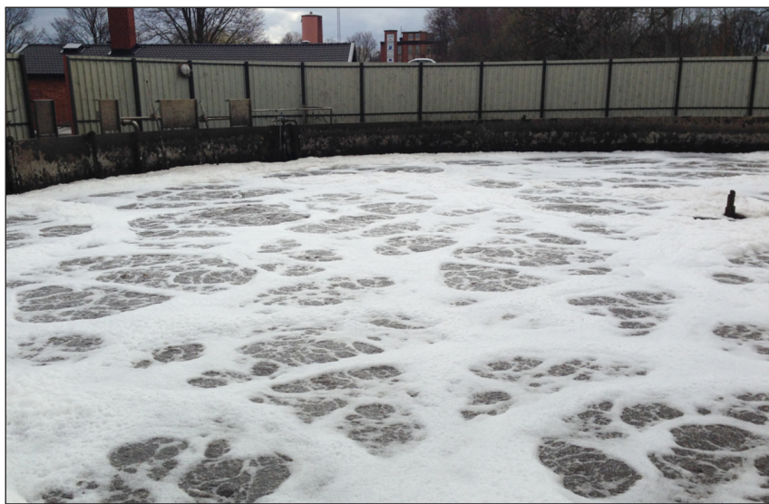
Figur 8-7 Luftningsfas i SHARON-reaktorn vid Nykvarns avloppsreningsverk.
