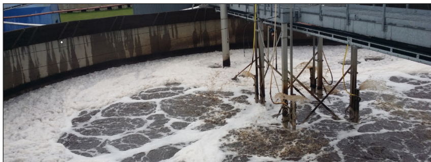
Figur 8-4 Luftningsfas i SBR:en vid Sjölanda avloppsreningsverk. På fotot syns även vattenspritsarna för att slå ned bildat skum. Foto: Ylva Eriksson.
