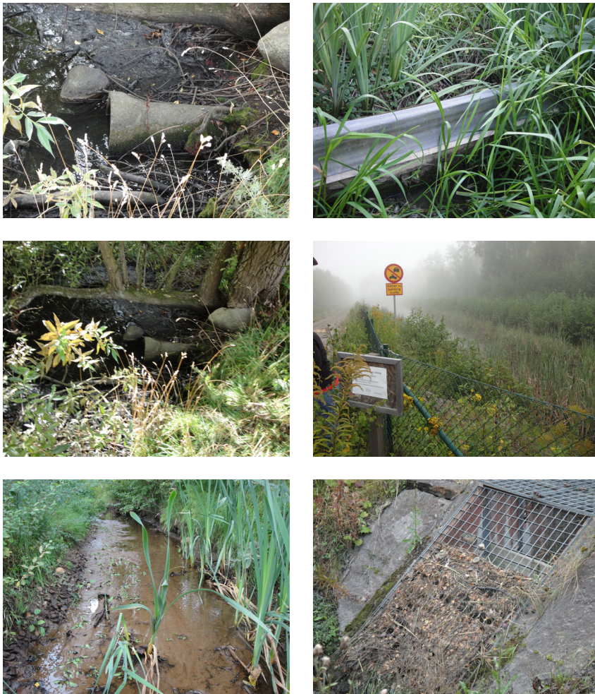
Figur 3.2 Bilderna visar olika problem i dagvattendammar: Ansamling av sediment och skräp vid inloppet (uppe till vänster), skada på utloppskonstruktionen (uppe till höger), träd och vedartade växter nära inlopp och utlopp (mitten till vänster), ett stängsel och tät vegetation som hindrar maskiner att komma in (mitten till höger), ansamling av sediment vid utloppet (nere till vänster) och ansamling av skräp vid utloppet (nere till höger).
