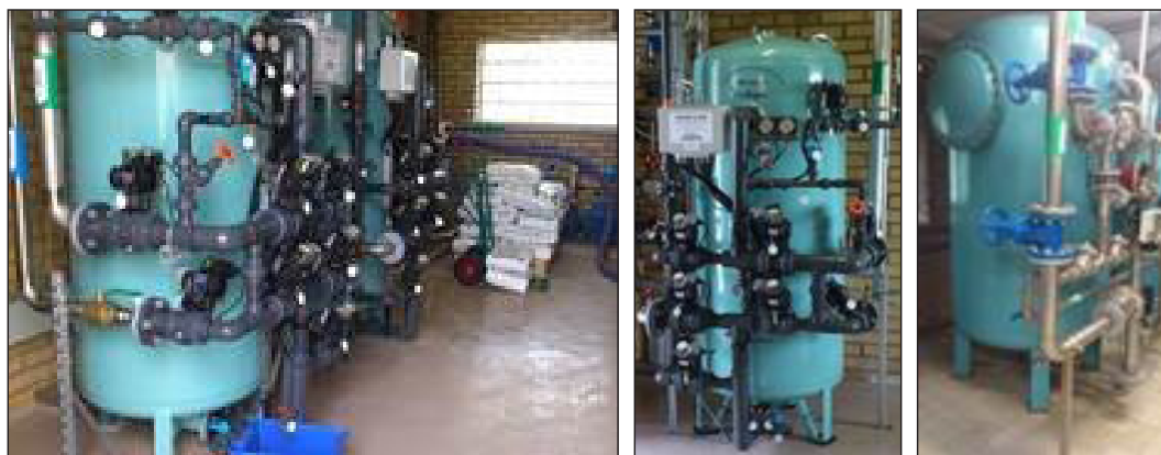
Figur 3.3 Jonbytaranläggning i Vänge Vattenverk, Uppsala kommun. Bild från Uppsala Vatten.
