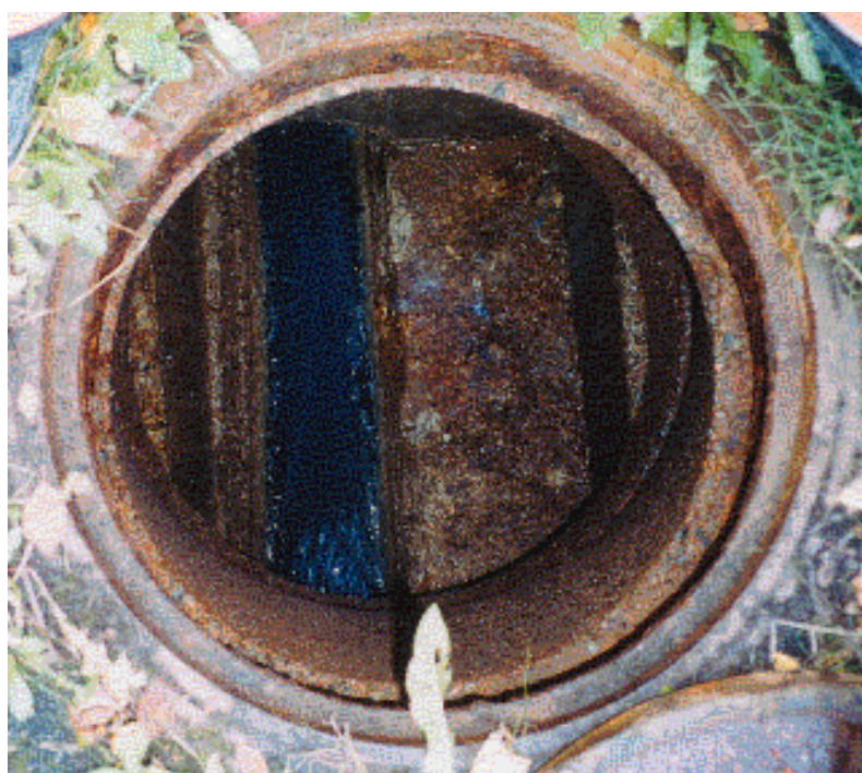
Bild 1.2 Anfrätt nedstigningsbrunn före renovering.
