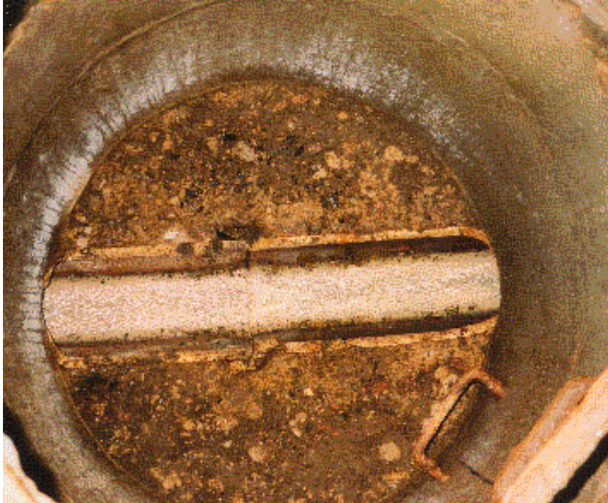
Bild 2.2.7. Skador i brunnsbotten.
