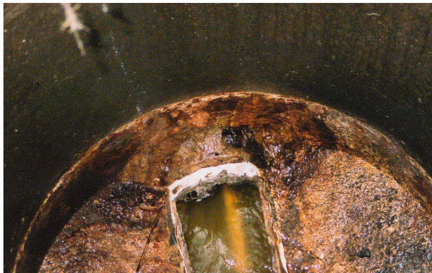
Bild 1.1 Underhållsbehov finns i många nedstigningsbrunnar.
