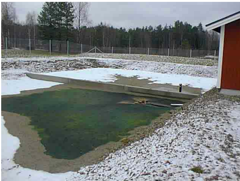
Infiltrationsbäddar vid vattenverket i Ytterhogdal
