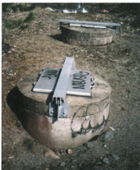
Bild 4.11. Tidigare djupinfiltration vid Fågelbacken, Västerås. Bilden visar en mät- och en infiltrationsbrunn som tagits ur drift. Nuvarande infiltrationsanläggning med "slukhål" skymtar i bakgrunden, se detalj bild 3.31.
