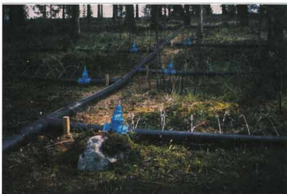
Bild 4.14. Sprinkleranläggning i Tavastehus, Finland.
