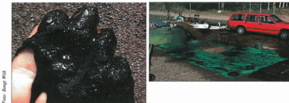
Bild 4.10. Rensning av infiltrationsbrunn vid Sandköping, Kristinehamn. Brunnen var kraftigt igensatt av mangan (den svarta utfällningen på handen t v) och det som missfärgar det uppumpade vattnet på bilden t h.
