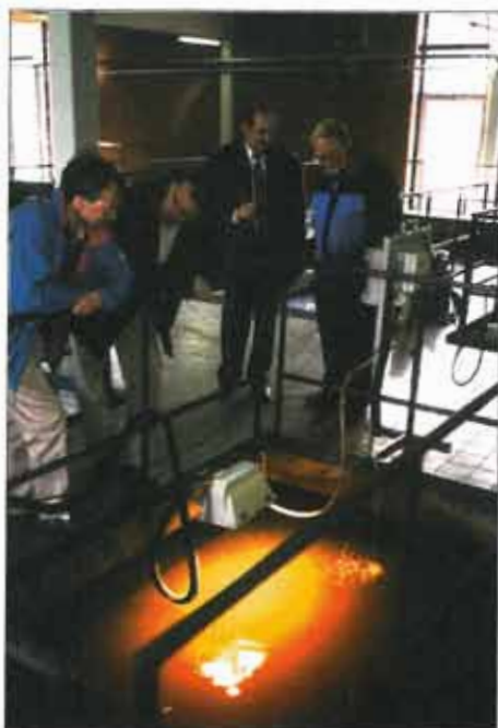
Bild 5.4 Flockningsbassäng i vattenverket vid Skrämså, Örebro under utprovning av en apparatur för optimering av kemikaliedosering. På bilden ses Royne Larsson (två från vänster) i diskussion med en grupp från VBB VIAK (fr v Bengt Dahlberg, Husam S Jabur och Thorsten Blomquist)
