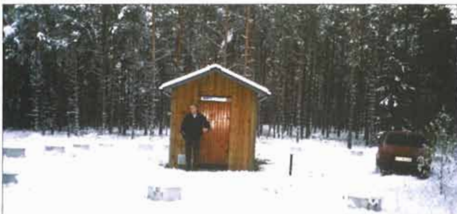
Bild 5.13 Vyredox IV-anläggning vid Högåsen, Nyköping - Oxelösund. Utanför pumphuset står driftingenjör Alf Dahlin.
