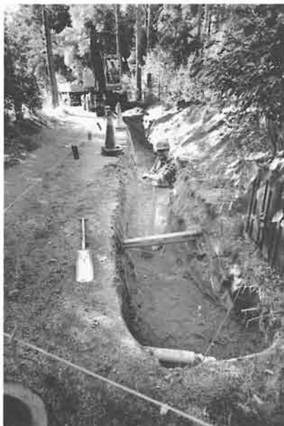
Bild 4. Delvis återfyllt schakt för PSS-ledning. Ledningarna lagda på frostfritt djup cirka 0,7 m.
