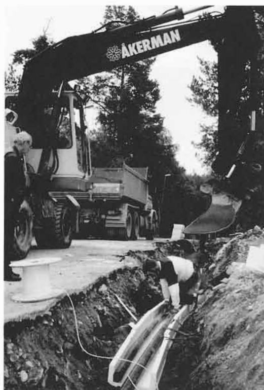
Bild 12. Läggnig av tryckavlopps- och vattenledningar ingående i ett PSS-system. Ledningarna läggs på cirka 0,7-0,8 m djup i sandfylld isolerlåda som är försedd med värmekabel.
