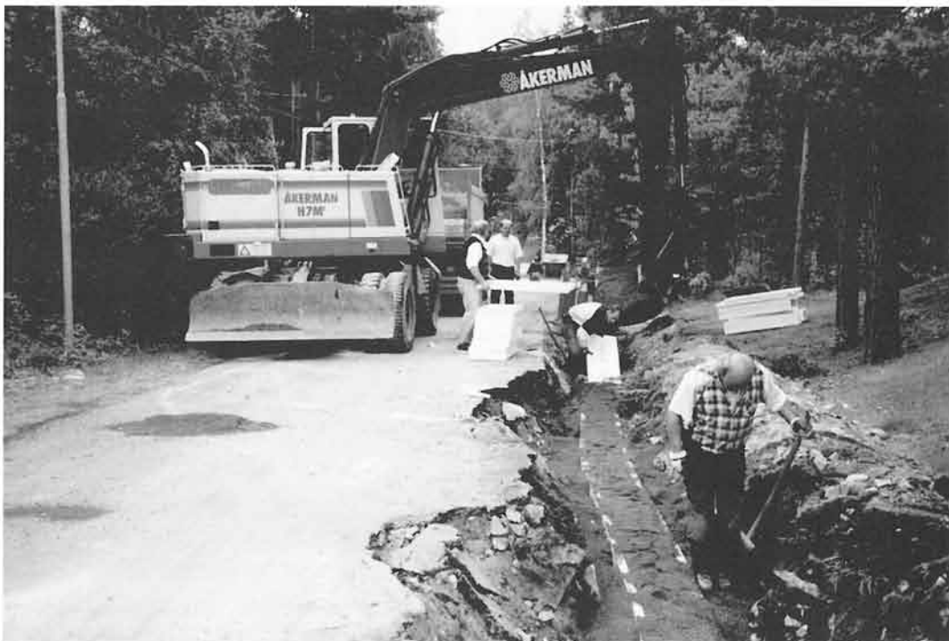
Bild 9. Läggnig av vatten- och tryckavloppsledningar i isolerlåda. Fyllning runt rören klar och isolerlocket håller på att läggas på.
