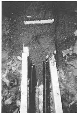
Bild 6. Detalj av vatten- och tryckavloppsledningar i isolerlåda. Observera värmekabeln mellan rören.
