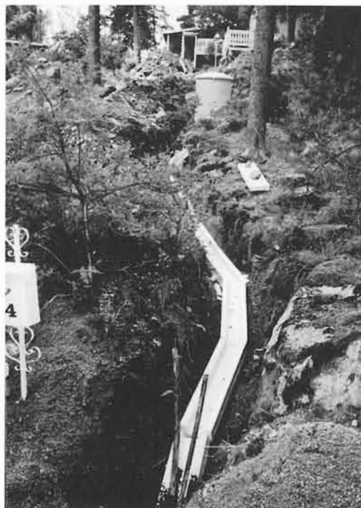
Bild 11. Grunt förlagda servisledningar förlagda i isolerlåda. Pumpstationen skymtar i övre delen av bilden.
