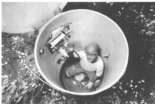
Bild 3. Interiör från servicedel av pumpstation typ LPS, äldre modell.
