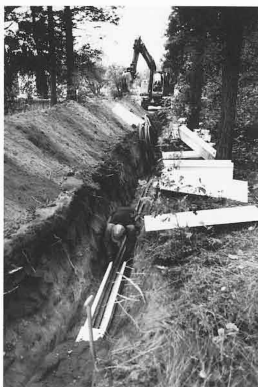
Bild 13. Läggnig av tryckavlopps- och vattenledningar. Ledningarna läggs även här i isolerlåda men på något större djup varför värmekabel inte erfordras.
