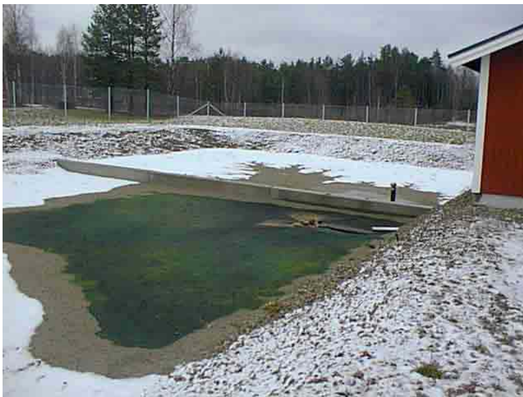
Infiltrationsbäddar vid vattenverket i Ytterhogdal
