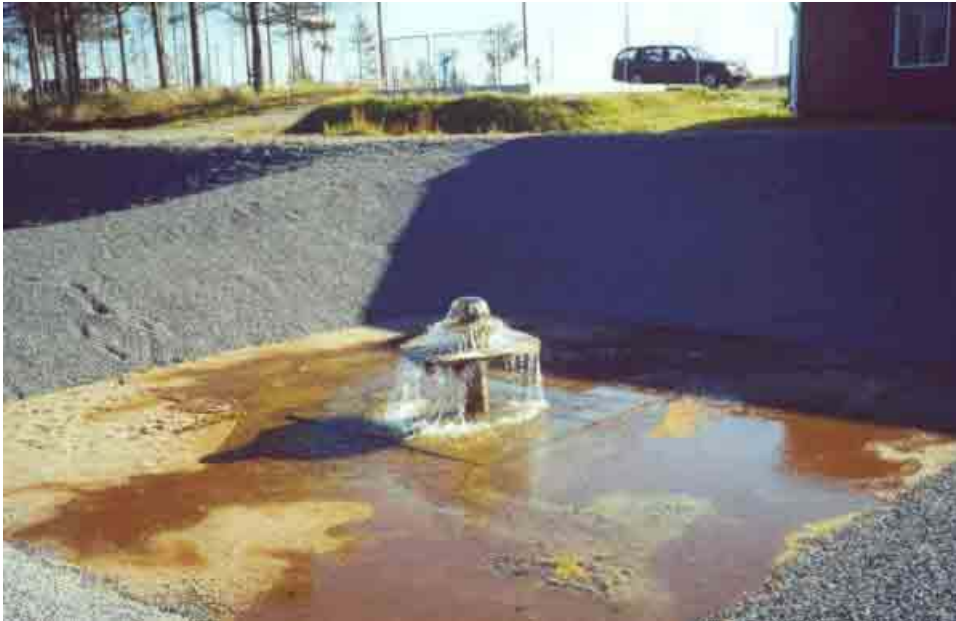
Infiltrationsbädd med kaskadluftare
