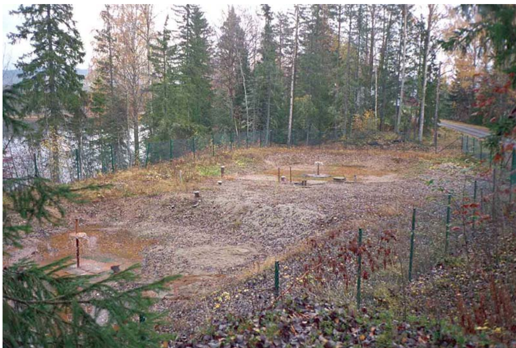
Infiltrationsbäddar i Norrflärke
