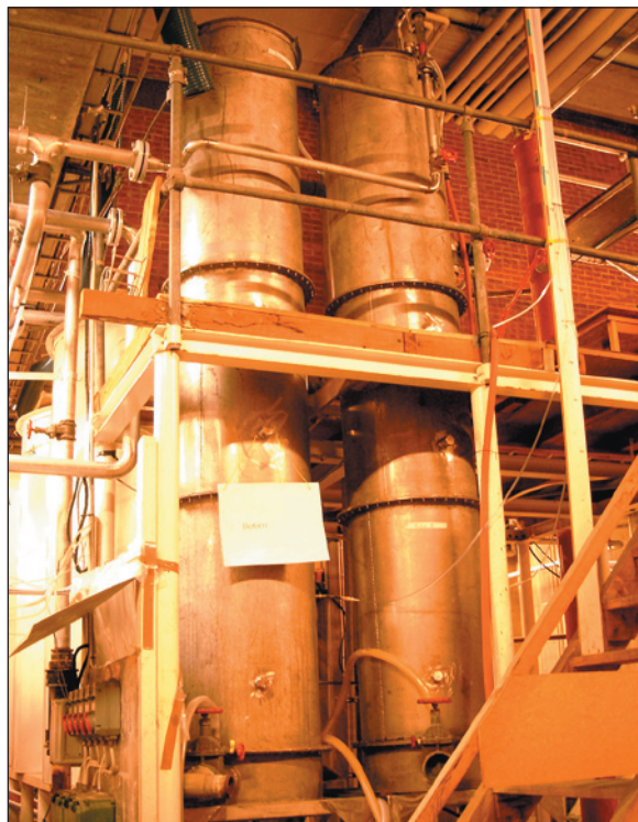
Foto 4-1. De två biotornen. Detaljerade anläggningsdata se bilaga A.
