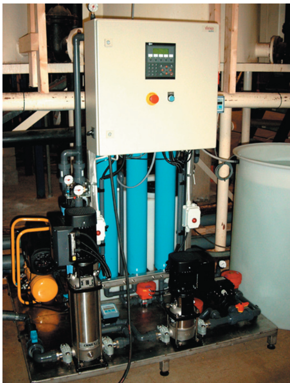
Foto 4-2. Pilotanläggning för nanofiltrering. Under automatiskåpet syns de tre vertikala tryckrör som innehåller membranen.
