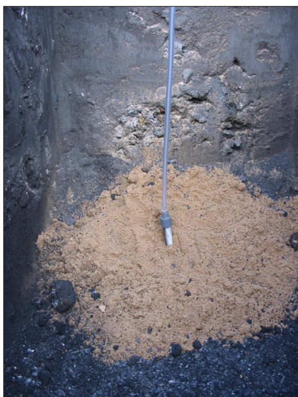
Figur A-6. Exempel på installation av gasprob.
