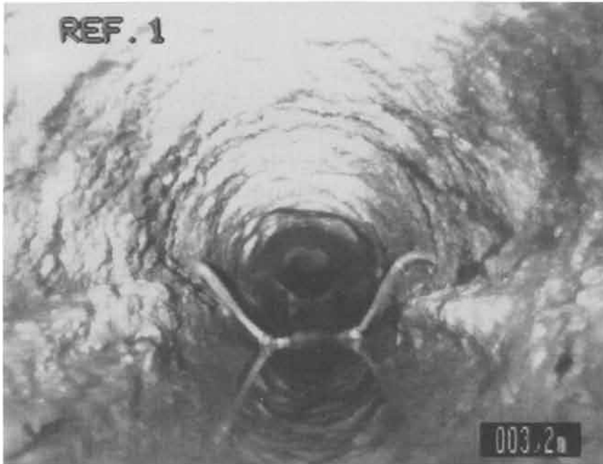
Fig 7. Svavelsyrakorrosion i Stureforsledningen
