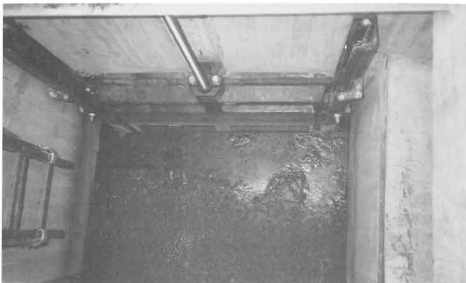
Exempel på reglering med rörlig lucka. Bilden tagen uppifrån.
