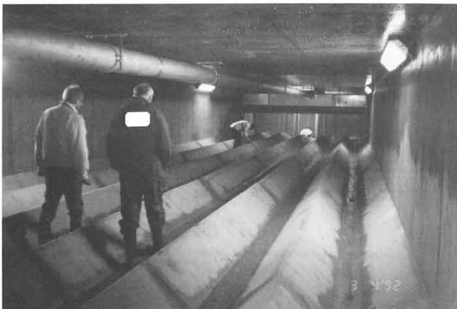
En mindre vanlig bottenutförning är en veckad botten så kallad "Tobleronebotten" som även möjliggör kontinuerlig rensning via spolsystem.
