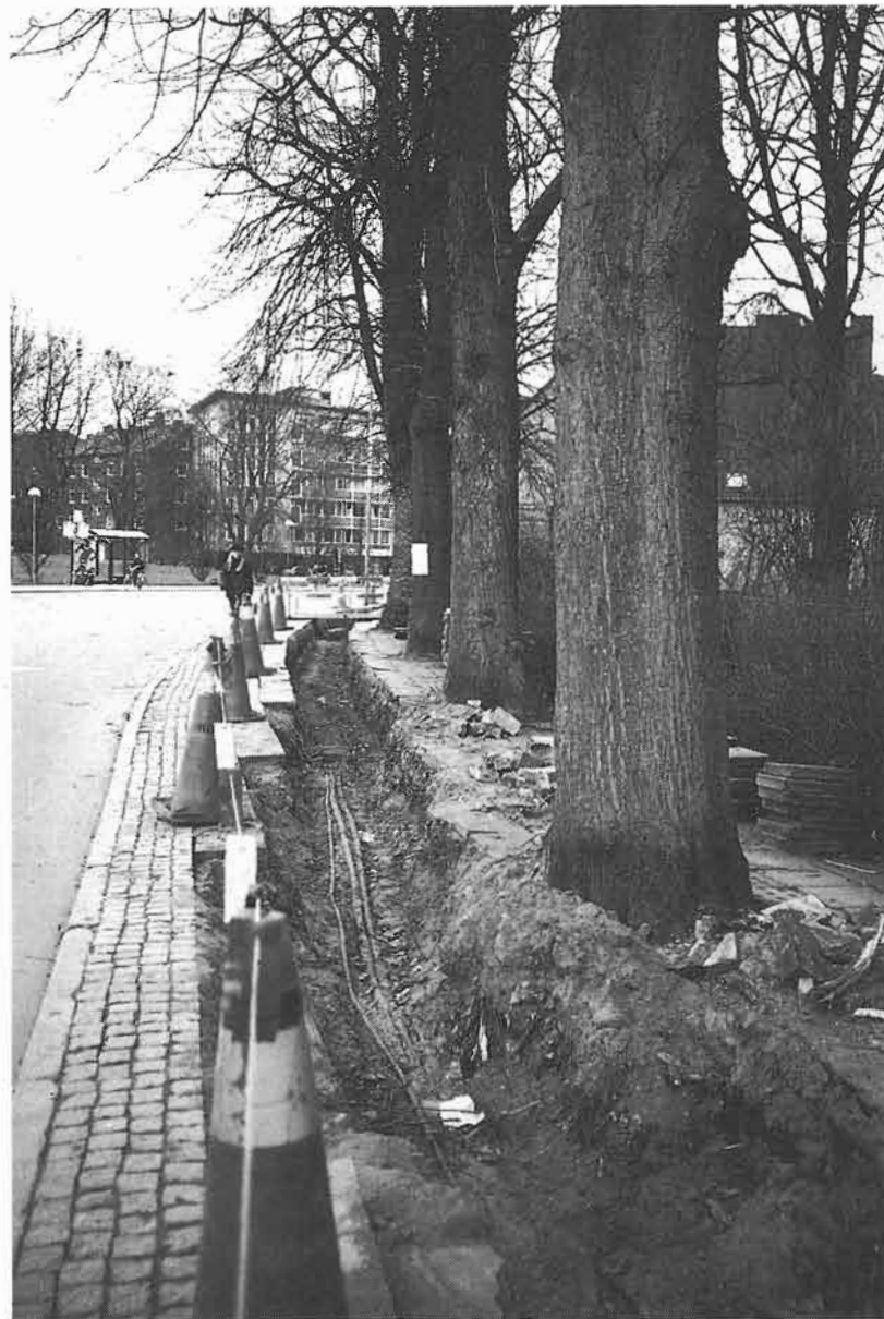
Figur 9. Stora befintliga träd negligeras ofta i stadsmiljön med bl.a. avkapning av stora rötter nära trädets stam. (Foto: Örjan Stål)
