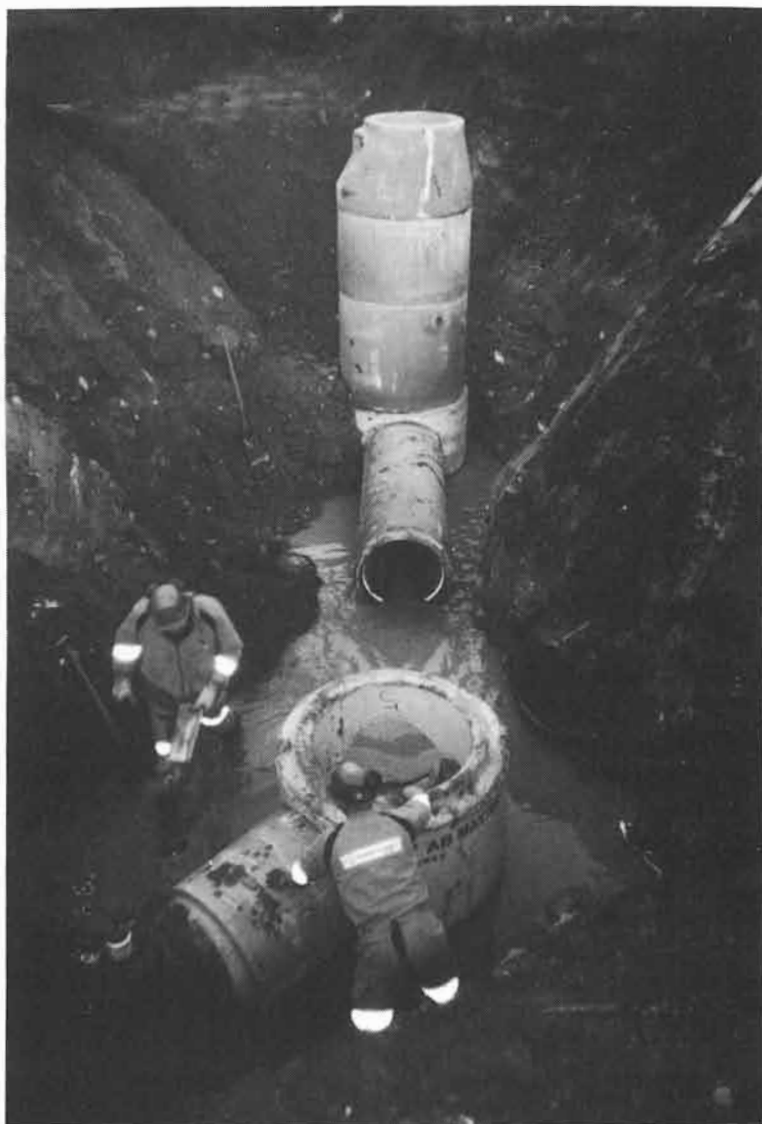
Figur 16. Fogarna på både PVC-rör och betongrör har kontinuerligt utvecklats och förbättrats. Däremot släpper utvecklingen efter när det gäller täthetskraven hos övergångar mellan dessa bägge rörmaterial och övergångar till brunnar och servisledningar. Även tätningen mellan brunnslöck och brunnringar verkar vara undermåliga. (Foto: Jan Schöön)
