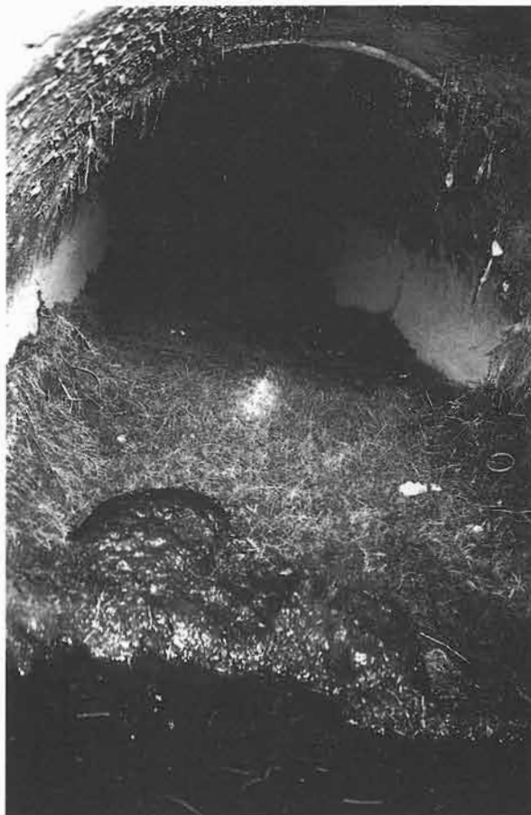
Figur 5. Ovan ett område med ett nedgrävt dagvatten magasin i direkt anslutning till vägen och "stubba-pilarna". Nedre bilden visar rotinträngning av stor omfattning i dagvattenmagasinet (1000 mm i diameter) där 30 kubikmeter rötter har fått handschaktas bort. (Foto: Örjan Stål)
