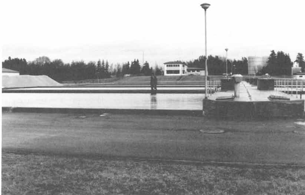
Figur 2. Långsamfilter vid Berggårdens vattenverk, Linköping.
