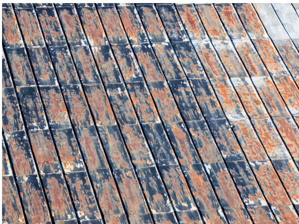
Figur 3.4 Korrosion av metalliskt byggnadsmaterial.
