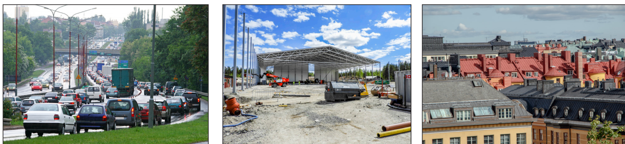
Figur 3.1 Trafik, byggarbetsplatser och byggnadsmaterial är alla viktiga källor till dagvattenföroreningar.
