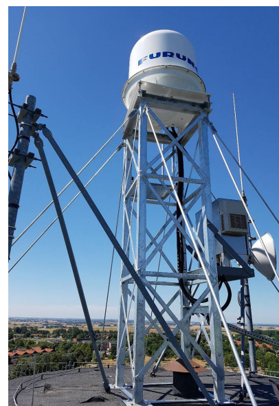
Figur 3.3 Väderradaranläggningen i Dalby med stativ, sommaren 2018
