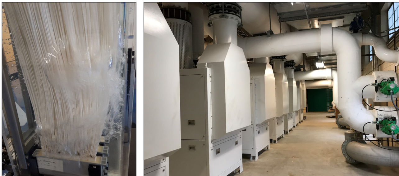
Figur 4.2 Luftning av visningsmembran i renvatten (John's Creek EC) och blåsmaskiner (Ballenger McKinney).
