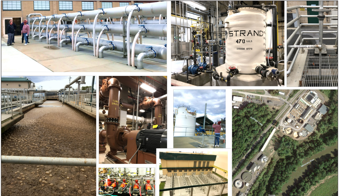
Figur 3.5 Bilder från Ballenger McKinney WWTP.
