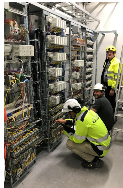
Figur 8-7 Styrsystem för ventilation (Käppalaförbundet, 2019).
