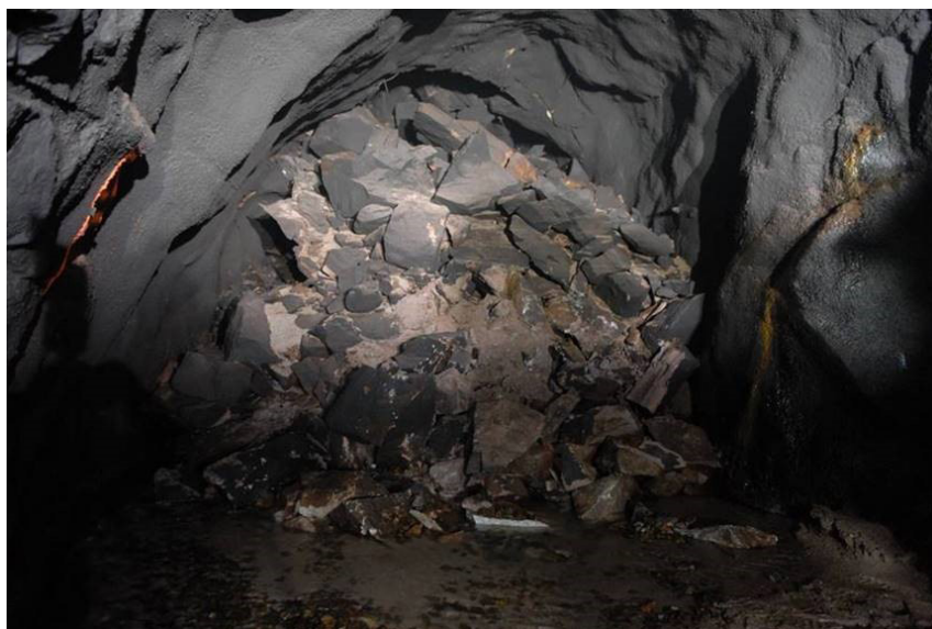
Figur 10-1 Ras i Bolmentunneln (Karlsson, 2019)
