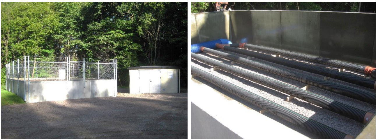
Figur 8-5 Kompostfilter i Hjällbo, t.v. filter samt fläkthus, t.h. filtrets insida utan bark/biomassa (Gryaab, 2019)
