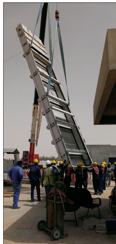
Figur 5-10 Installation av stort grovrensgaller (Nordic Water, 2017)
