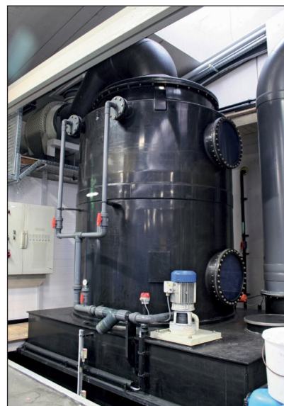
Figur 8-1 Skrubberanläggning från Gerhard Weber Kunststoff-Verarbeitung GmbH (Weber-Kunststofftechnik, u.d.).
