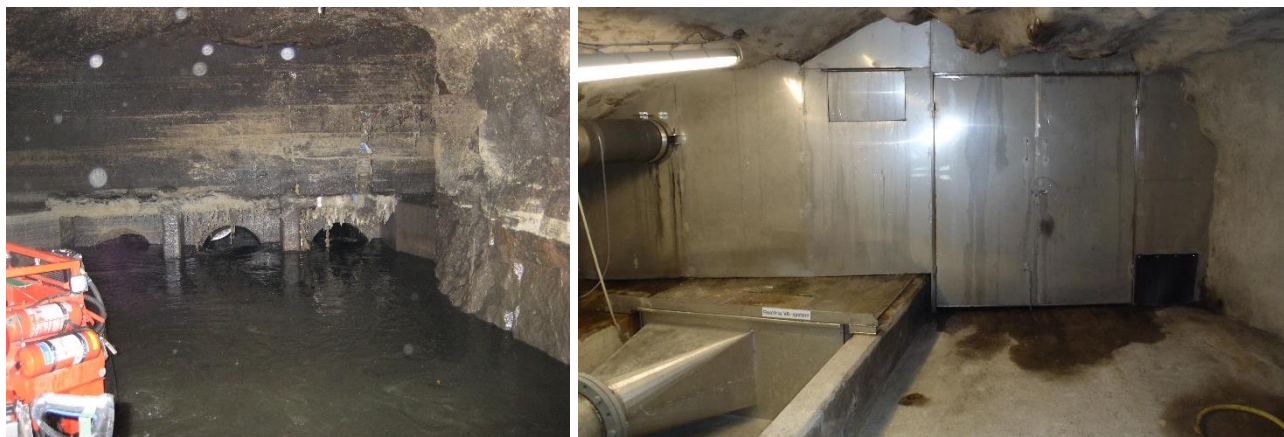
Figur 6-4 T.v.: Anslutning mellan våt tunnel och rör (Gryaab, 2019). T.h.: anslutning med mätning vid tunnelpåslag (Käppalaförbundet, 2019).
