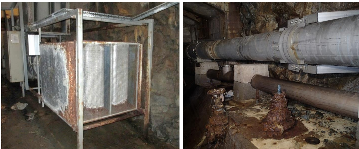
Figur 8-8 Exempel på korrosionsangrepp i tunnel, (Michael, 2019), (Händevik, 2016)
