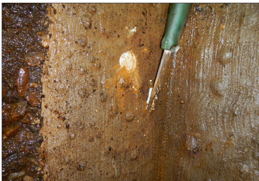
Figur 9.11 Applicering av tätskikt på befintliga betongkonstruktioner kan leda till att tätskiktet lossnar. Ofta sker detta i form av vattenfyllda blåsor.
