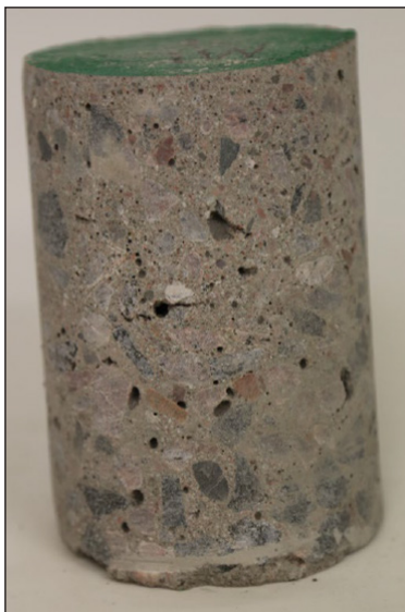
Figur 6.2 Utborrad provkropp med håligheter samt ej homogen betong
